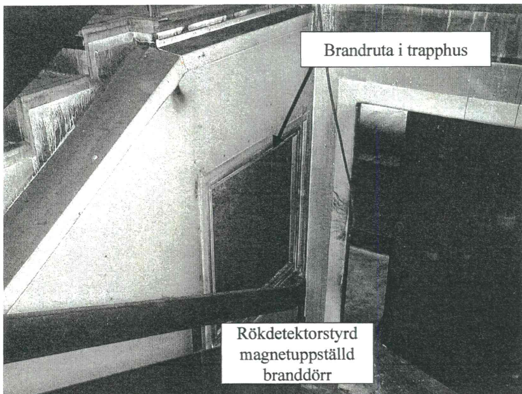
Bild 7 Brandcellsavskiljande fönsterparti (A 60) och branddörr (A 60) i trapphuset i mellan markplan och plan 1.
