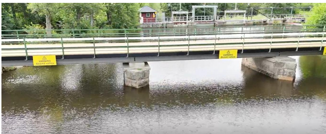
Bild 9: Drönbild. Varningsskyltar på bron för strömt vatten.
