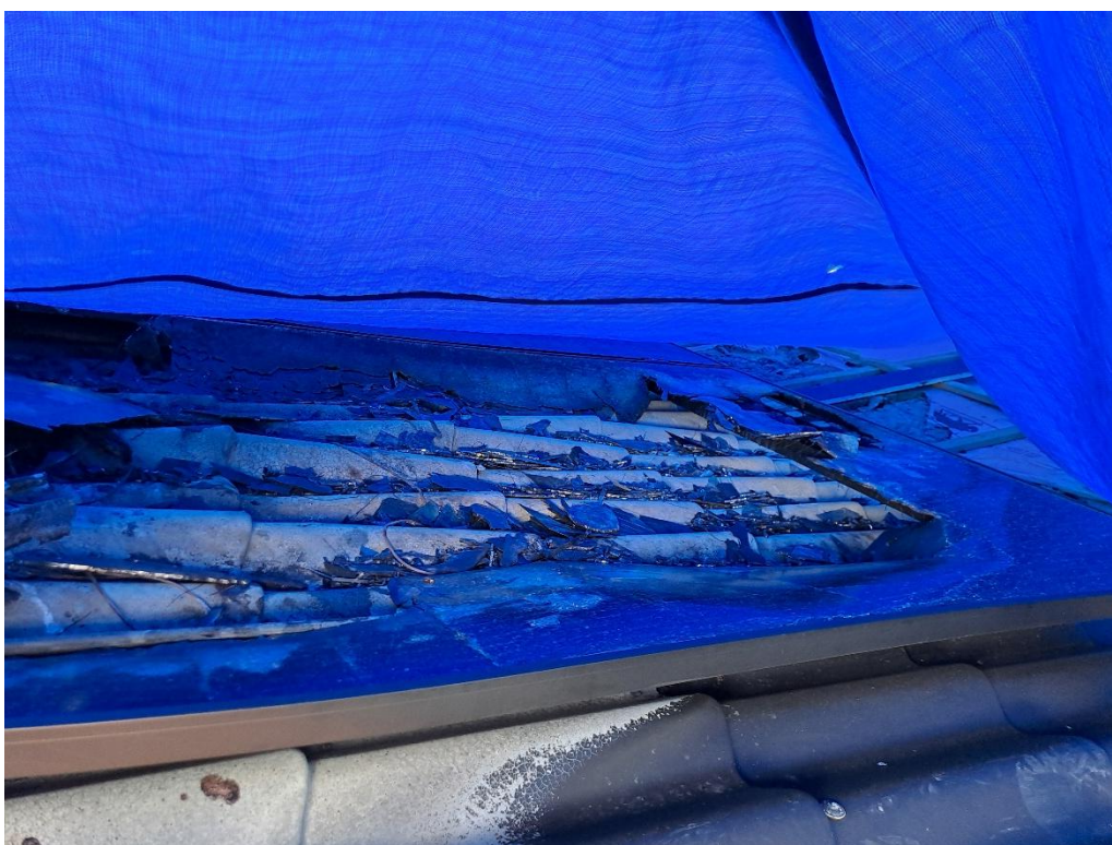
Figur 3. Skador på solcellspanel placerad precis ovanför takfot.
