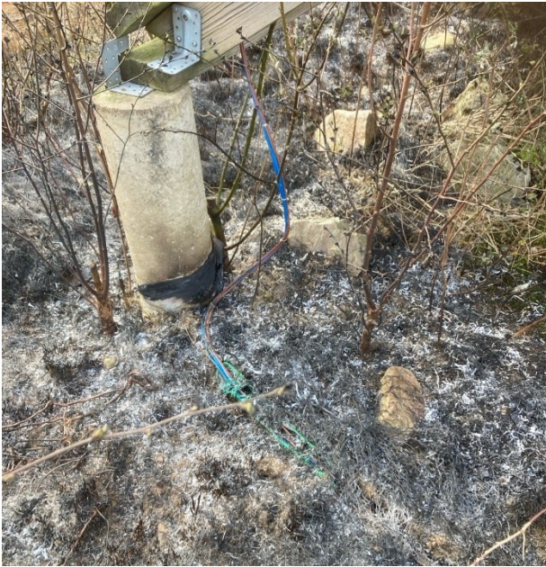
Figur 4. Kablage ner till marken från solcellsanläggningen. Källa: Räddningstjänsten Gislaved-Gnosjö.
