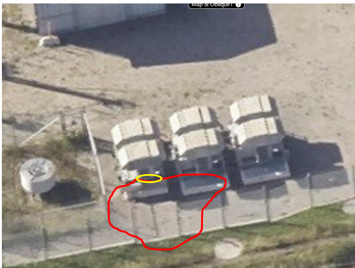
Figur 3. Bild hämtad från Helios. Röd markering isoleringsoljans spridning vid rämning av transformator. Gul markering brandens utbredning vid räddningstjänstens framkomst.
