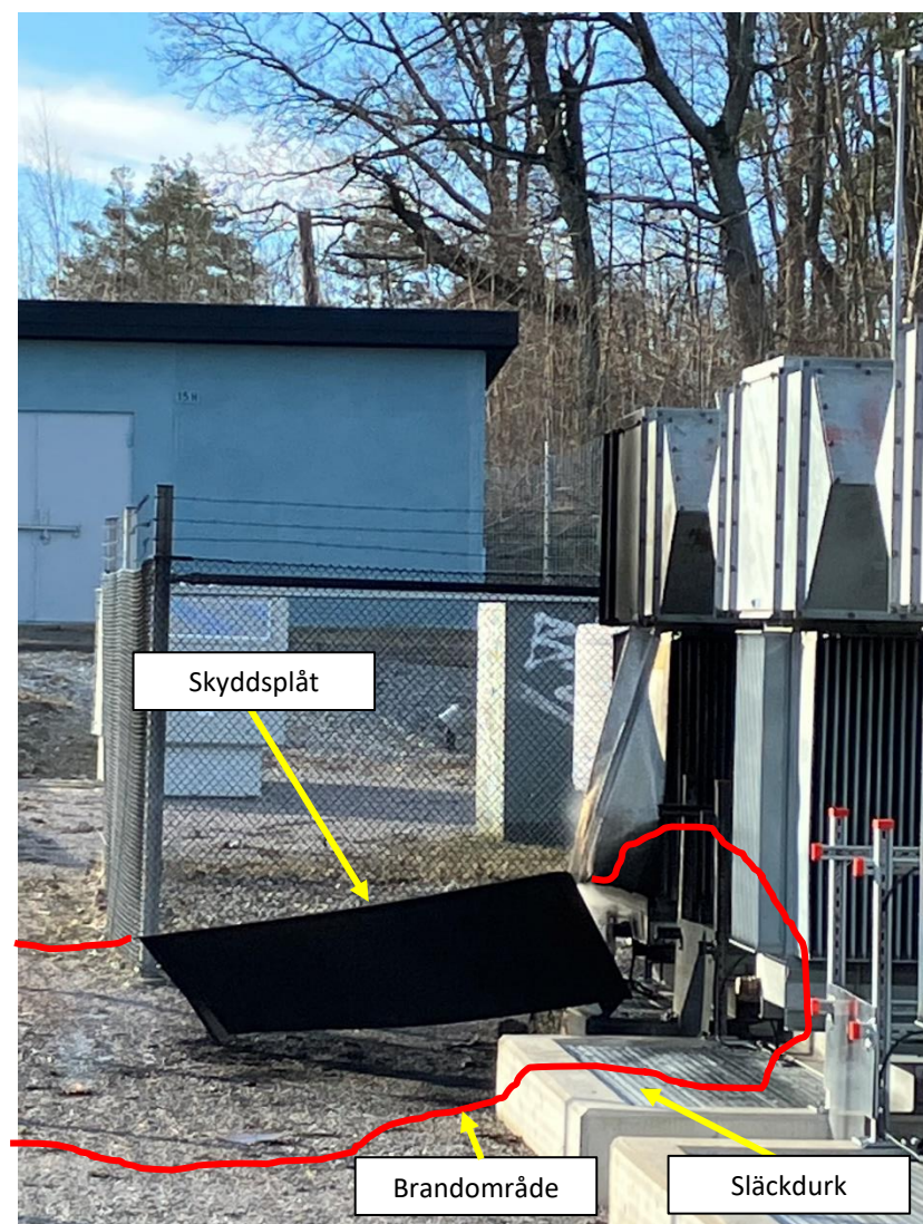
Figur 4 och 5. Skadad transformator. Bild tagen av insatspersonal 2024-03-18.
