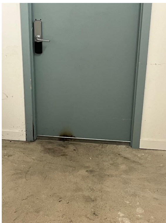
Figur 2. Dörren där branden anlades.
