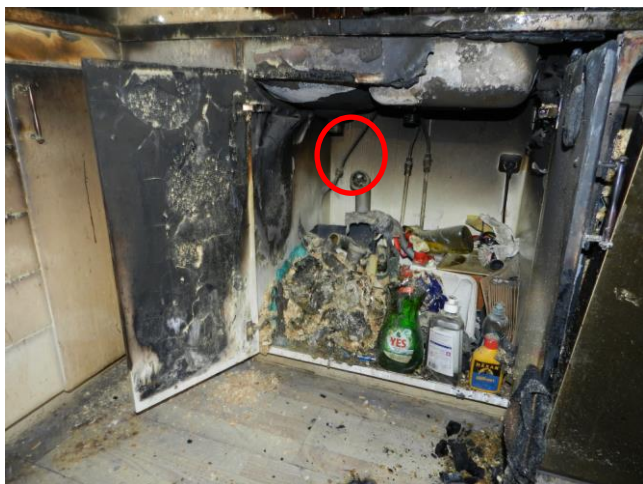
Diskbänkskåp, primärbrandplats, Slang till diskmaskin som brunnit av.
