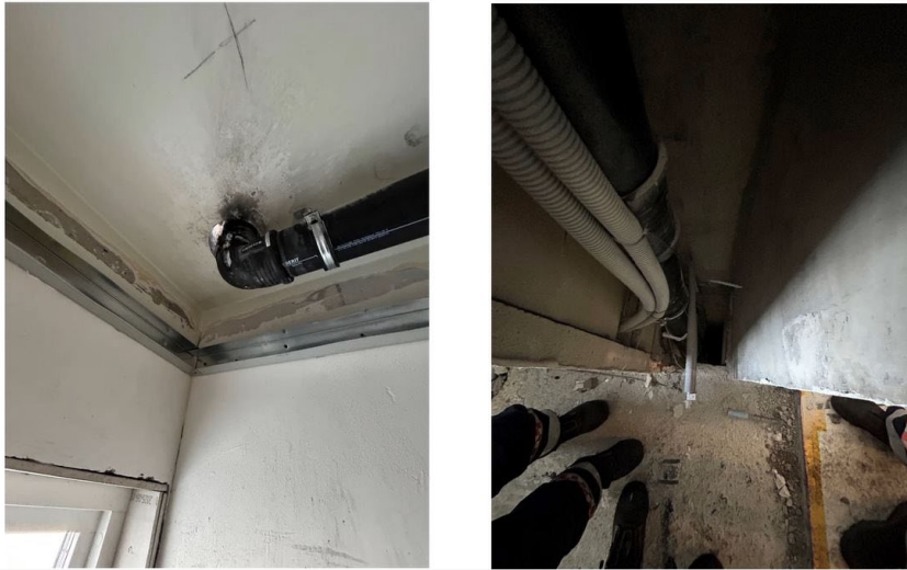
Figur 9 visar två exempel på otätheter i byggnaden. Källa RSG
