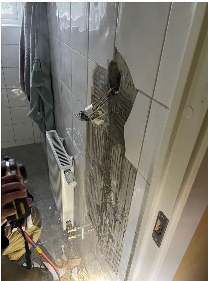
Figur 8 visar platsen där vattenläckan upptäcktes. Källa RSG
