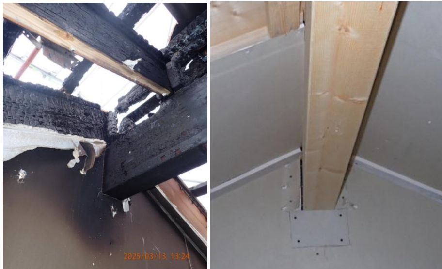
Figur 60. Taknock som passerar genom brandcellsgräns mellan lägenhet och trapphus i branddrabbad del av huset (till vänster) samt inom oskadad del (till höger).
