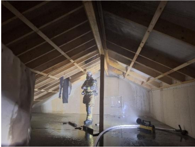
Figur 19. Bild från vindsutrymme närmast brandområde där Huddinge arbetar med att begränsa branden.
