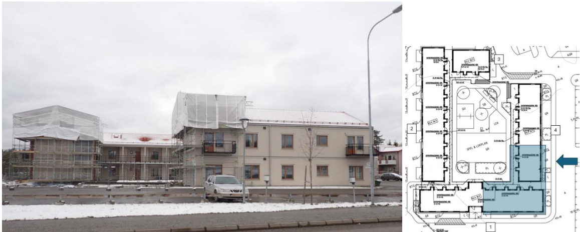
Figur 26. Kvarvarande huskroppar efter branden. Till vänster i foto syns platsen där de brandutsatta lägenheterna fanns innan rivning. Fotografiet är taget i riktning enligt blå pil.
