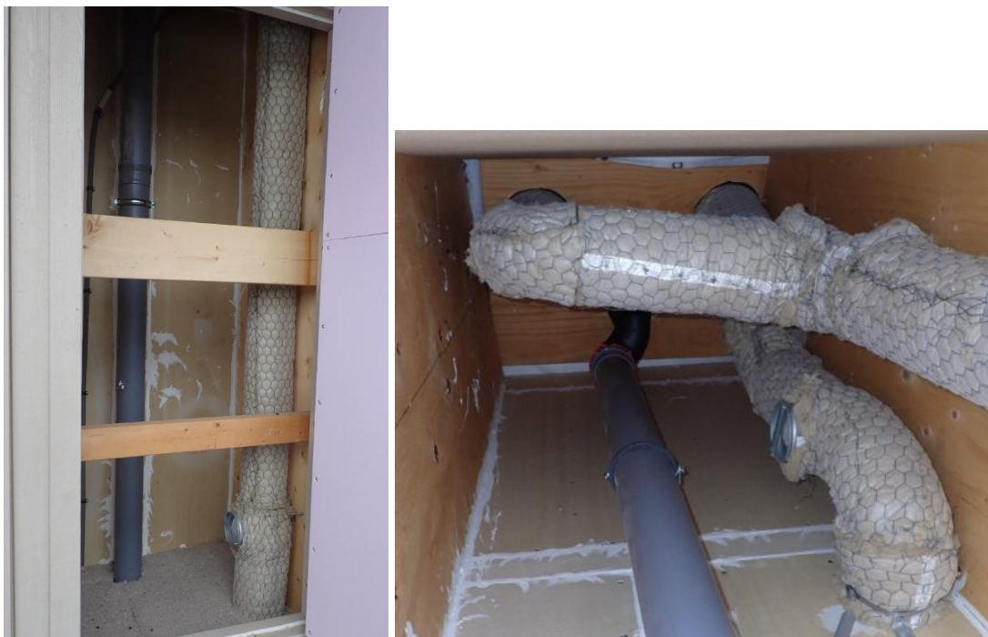
Figur 37. Samma schakt som Figur 36. Till höger syns schakttopp där kanaler passerar taket.
