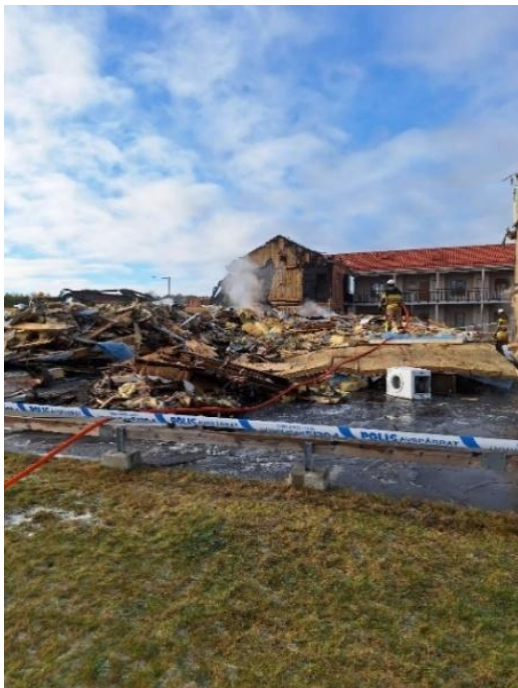
Figur 24. Glödande massor som finns kvar efter rivning av delar inom både huskropp 1 och 4. Personal från räddningstjänsten kvar på plats. Polisier avspärrning går att urskilja.
