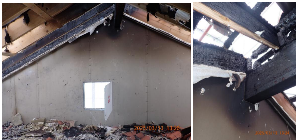
Figur 43. Vind ovanför trapphus, bild tagen i riktning mot vägg till brandutsatta lägenheter (till vänster), närbild på nockbalkens genomföring (till höger). De gipsskivor som fanns mot takstolar har rivits i samband med släckarbetet.
