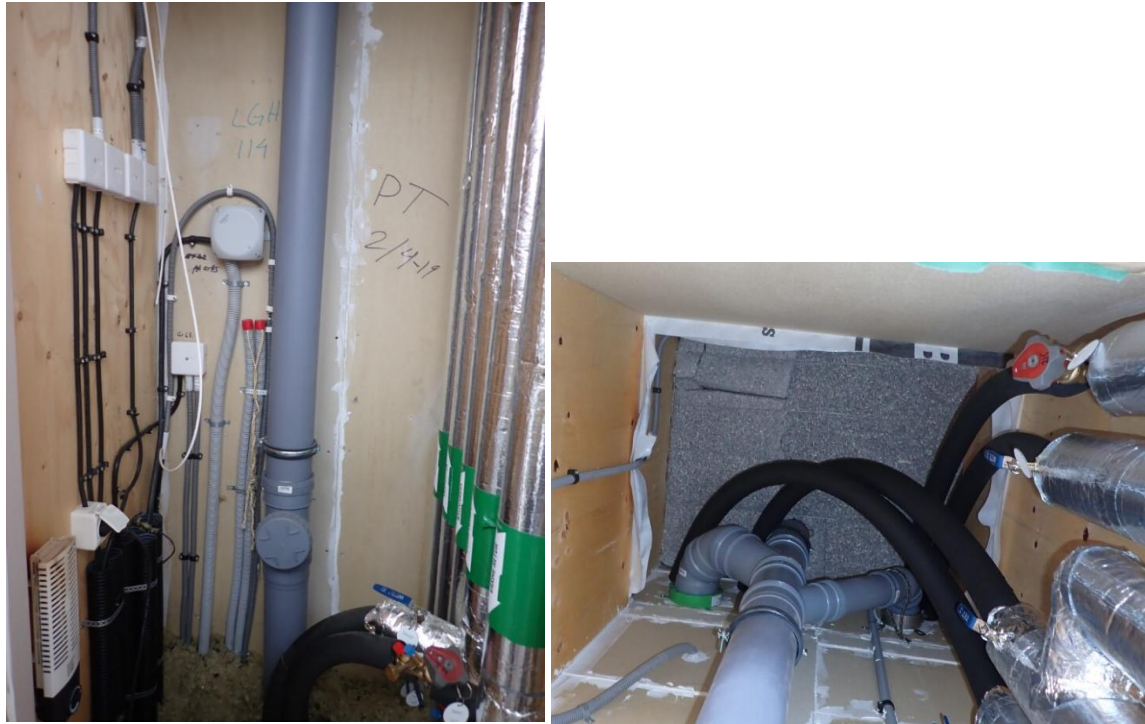
Figur 38. Installationsschakt i huskropp 4 från våningsplan ett som inte innehåller ventilationskanaler utan rörinstallationer. I schakt förekommer ett element nere till vänster i vänstra bilden. Den högra bilden är tagen upp mot ovanvåningen och där går att urskilja att schakten är avskilda mellan våningsplanen.
