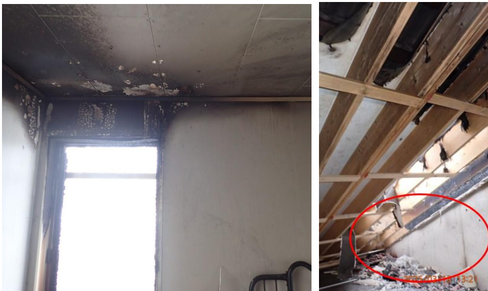
Figur 41. Trapphusets dörröppning mot den branddrabbade loftgången (till vänster) och vindsutrymme ovanför dörren (till höger).
