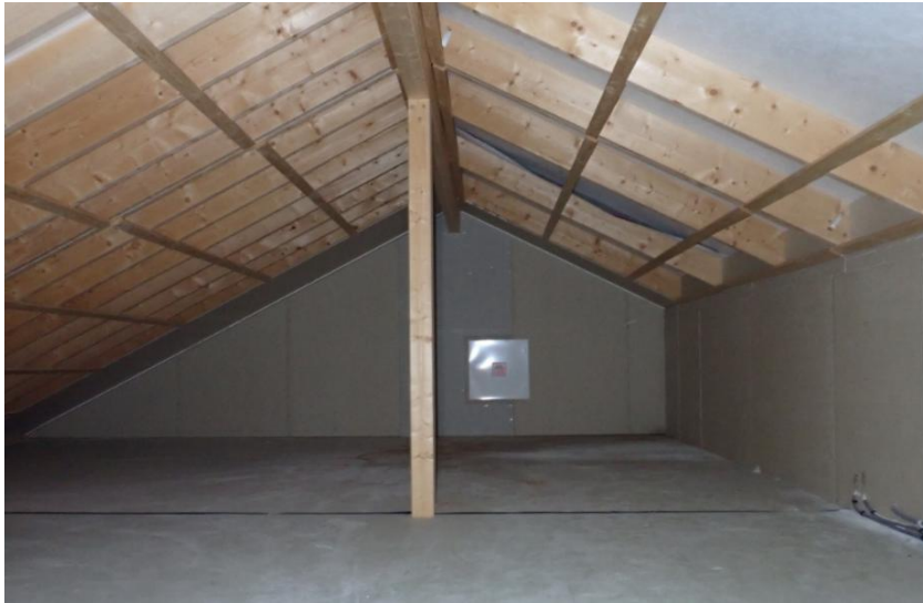
Figur 59. Oskadad del av byggnaden visar hur en intakt brandavskiljande vägg på vinden mellan lägenheter ser ut (längst bort i bild). Bakom den vägg som syns till höger i bilden är loftgången.
