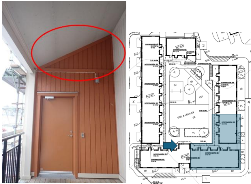
Figur 42. Dörr till trapphus från loftgång, inringad yta motsvarar den del av ytterväggen som vetter mot vindsutrymmet ovanför trapphus.
