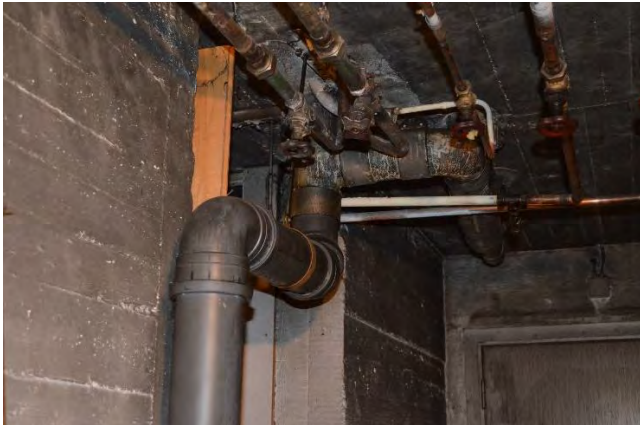
Exempel 2: Avloppsrör genom bjälklag (foto: räddningstjänsten)
