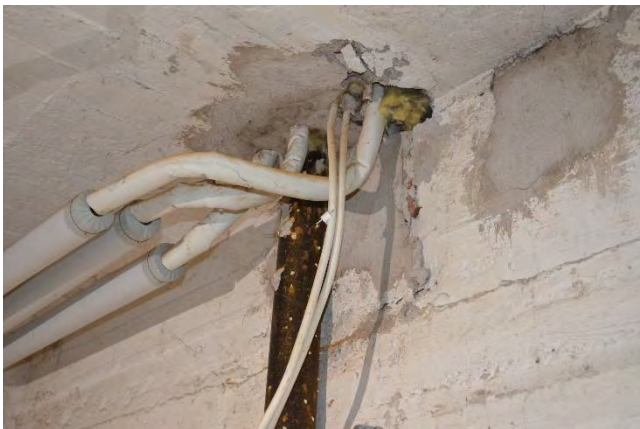
Exempel 1: Vattenrör genom bjälklag (foto: räddningstjänsten)
