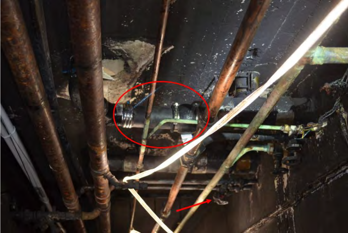
Rörmuff (inringad) och kran (pil), (foto: räddningstjänsten)
