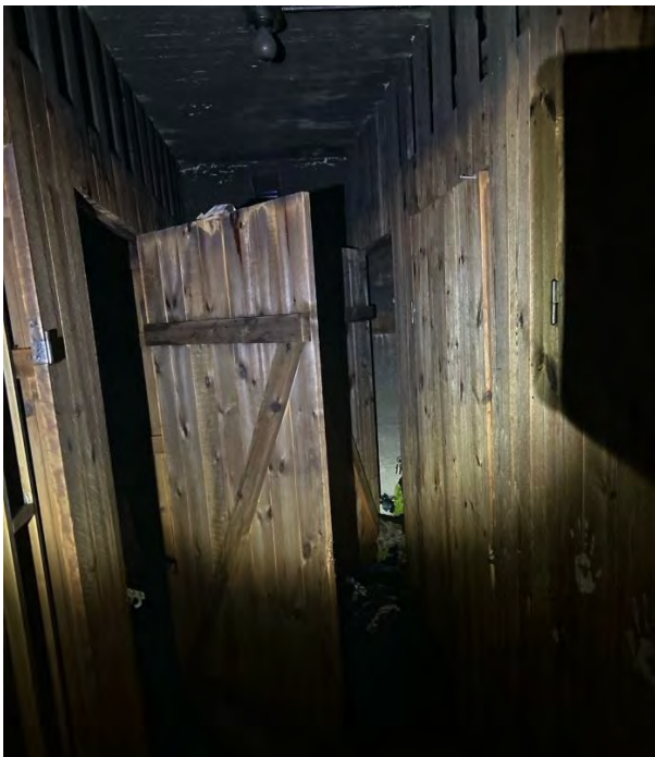
Vägg och dörr i angränsande förrådsutrymme, ej brandskadat (foto räddningstjänsten)
