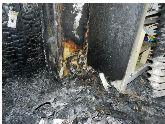
Vägguttag och stickproppar med skador från branden.
