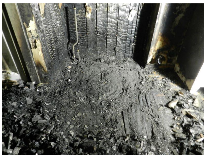
Brandskador i parkettgolvet och i nischen
