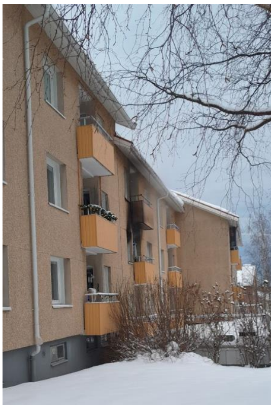
Brandskador genom fönster
