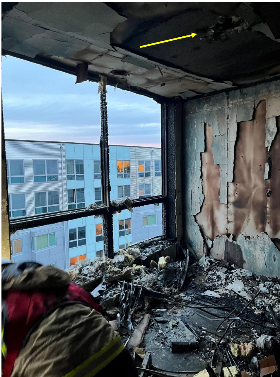
Figur 7. Risk i arbetsmiljön för fall med anledning av stora trasiga fönster. Brandgenombrottet i lägenhetstaket mot vinden markerad. Bild tagen av insatspersonal under insatsen.
