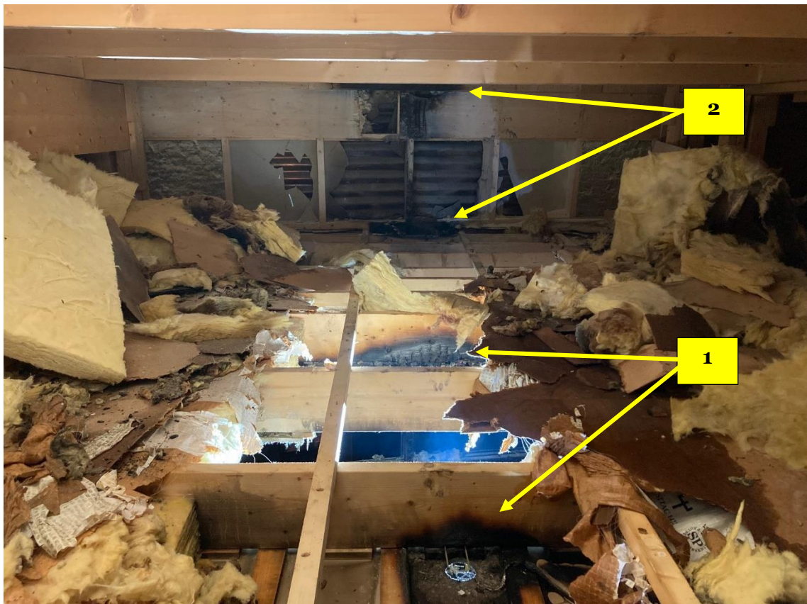
Figur 8. Krypvind med synliga brandskador i takkonstruktionen markering 1 och i väggkonstruktionen markering 2. Bild tagen av insatspersonal under insatsen.
