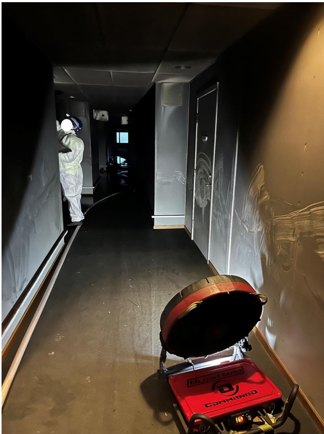
Figur 6. Rökskador i brandpåverkad korridor. Bild tagen av insatspersonal under insatsen.
