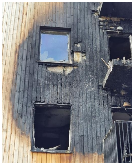
Figur 9. Brandpåverkad fasad, lgh 2a och 3a. Foto från Brandkåren Attunda.
