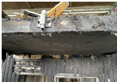
Figur 16. Brandskador mot ovanförliggande balkongplatta, lgh 3a.
