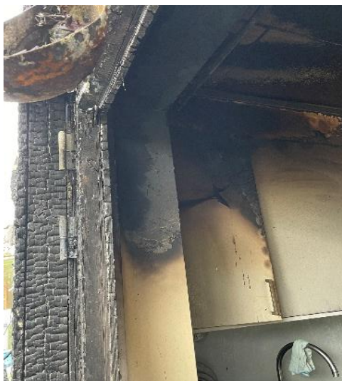
Figur 23. Balkongdörr lgh 4b.
