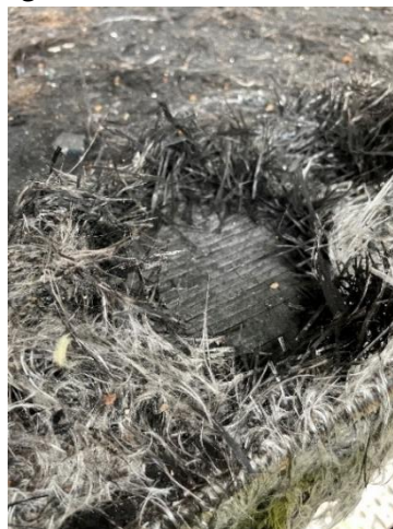
Figur 12. Brandskadad balkongplatta, lägenhet 2a. Ovensida.
