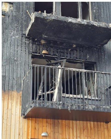
Figur 10. Brandpåverkad fasad, lgh 2a och 3a. Foto från Brandkåren Attunda.
