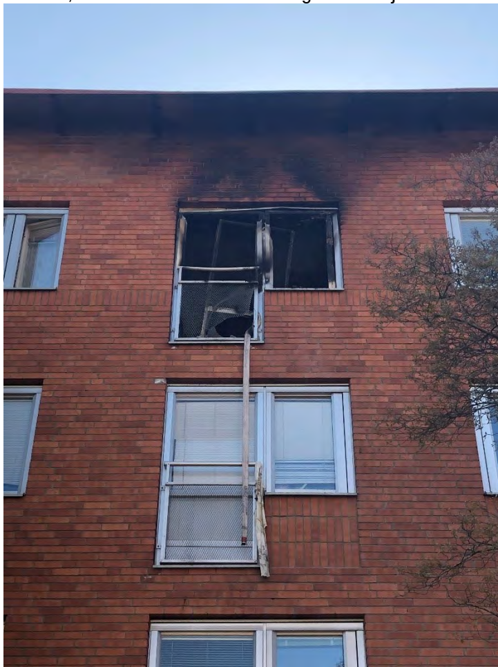
Figur 5 Branddrabbad lägenhet, sett från Pilvingegatan. Obrännbara plattor i takfot har fallit ner.
