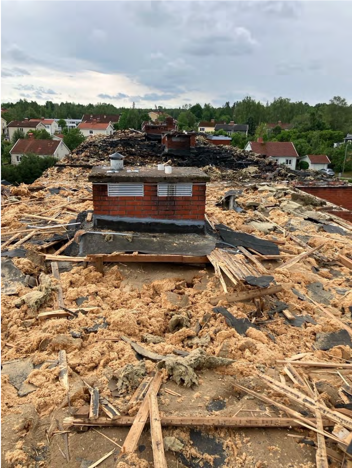
Figur 40. Foto av taket 2025-07-07 kl 13:47 - Larm 4. Fotografen står på taket till trapphus/sektion A. I bakgrunden syns resterande sektioner B-D.
