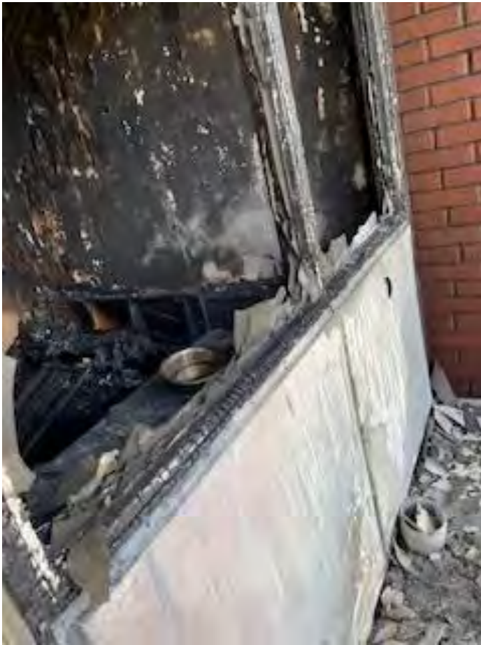
Figur 5 brand på balkong
