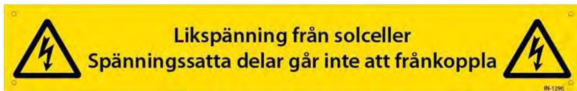
Figur 28 Klistermärke på kablage till växelriktaren
