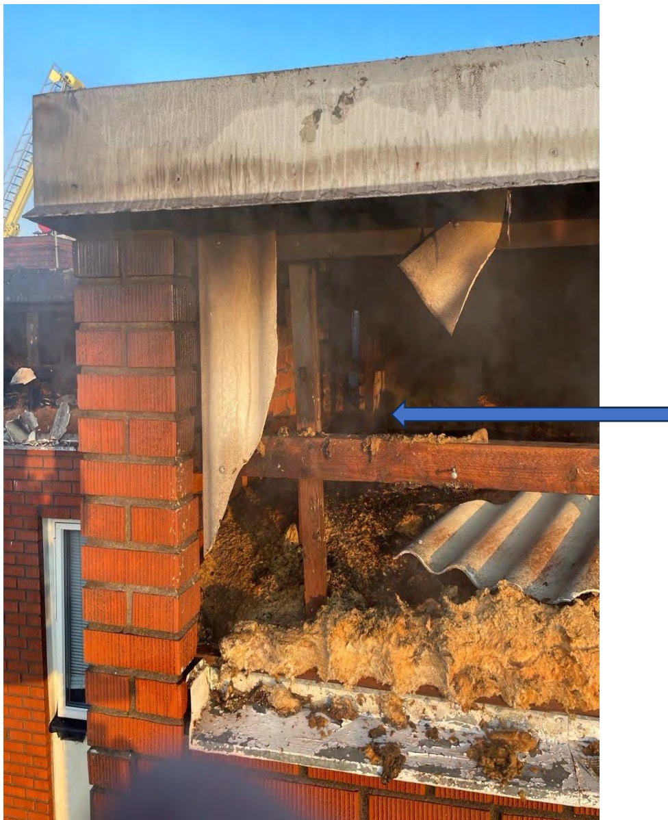
Figur 24. Bild visar brandcellsgräns som har en luftning eller delning som gjorde att varma brandgaser kunde ta sig förbi det tänkta stoppet av branden.
