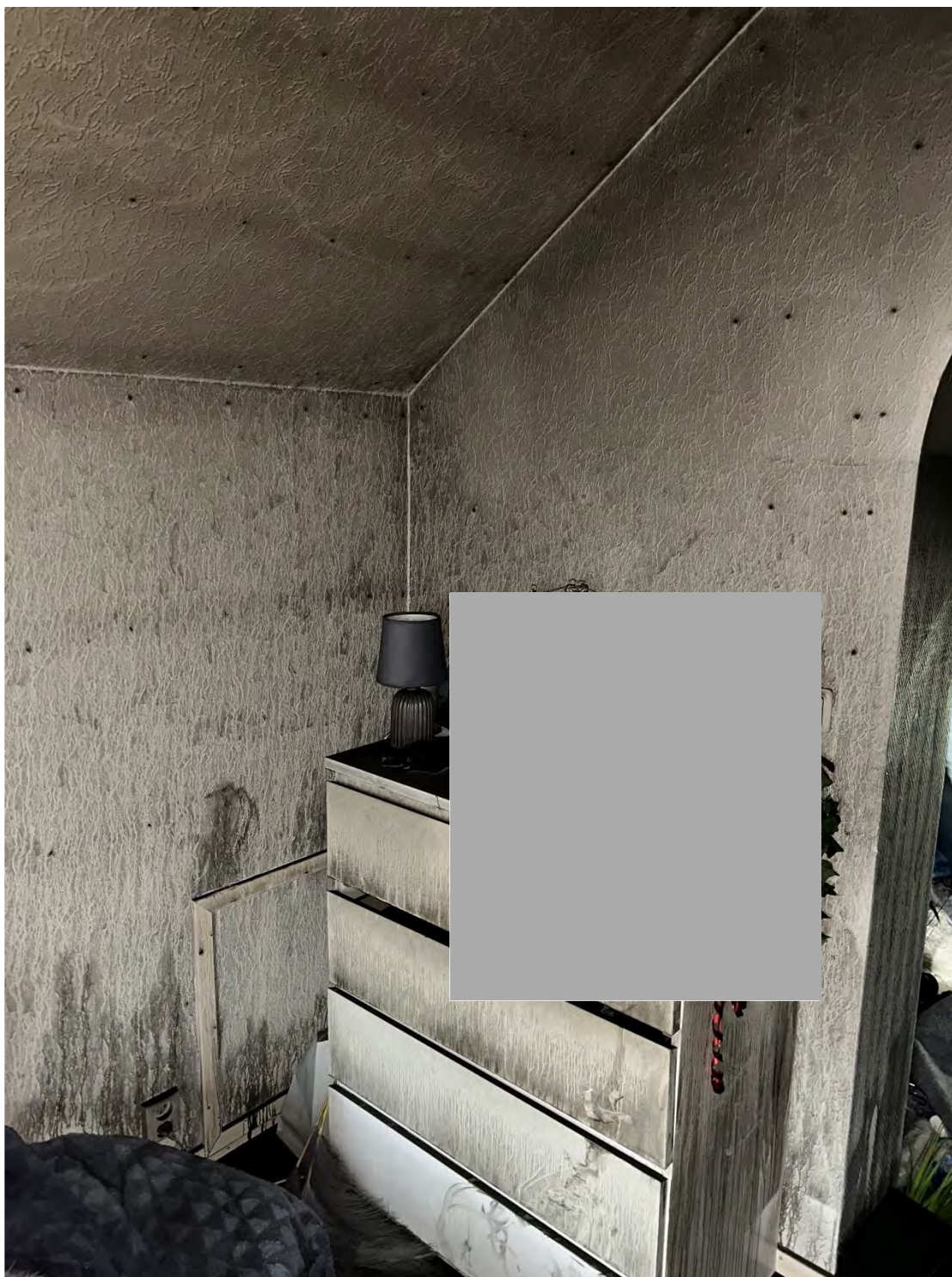
Figur 9 Rökskadad del av vardagsrummet/sovrummet. Vänster in från hallen.
