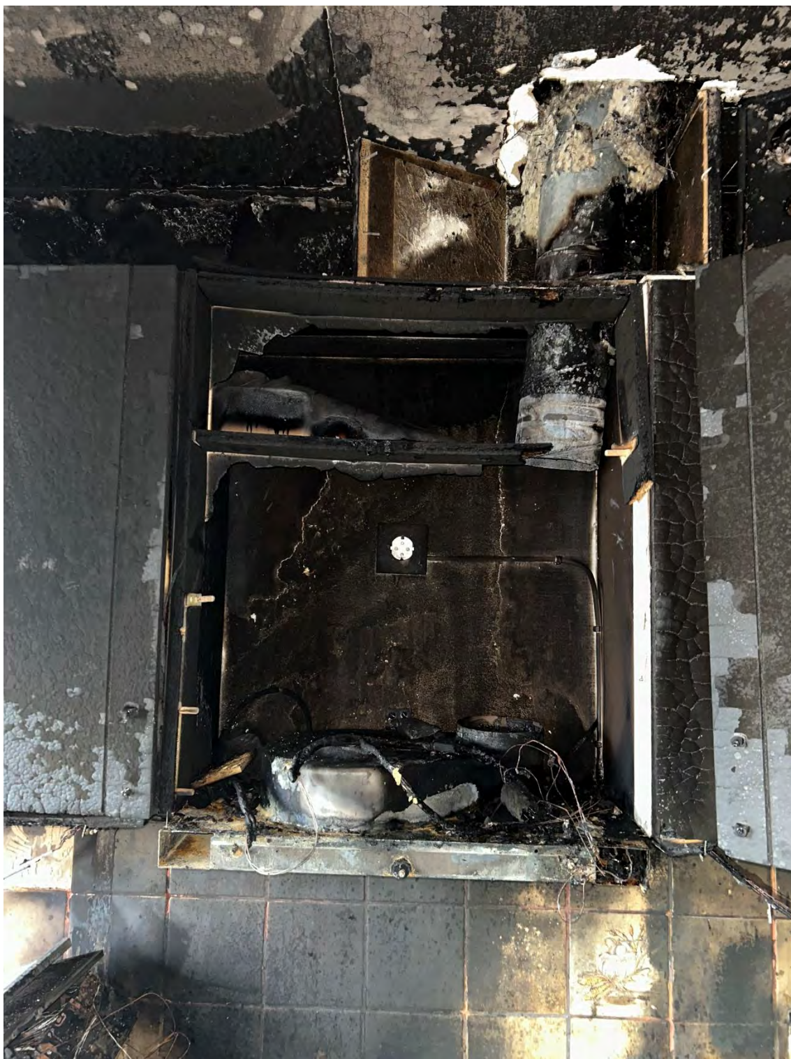
Figur 6 Bilden visar fläktskåpet samt intilliggande köksskåp. Ventilationsröret syns i ovankant vara blottlagt och delvis värmeskadad.
