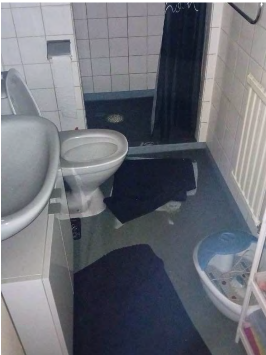
Figur 10 Badrummet påvisade ej stor rökpåverkan. Noterbart är den omkomnes telefon som återfanns i anslutning till toalettstolen nere till vänster.
