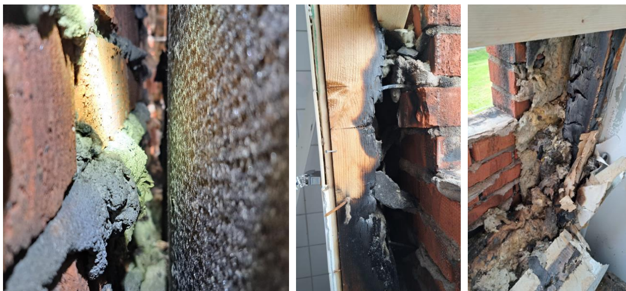
Figur 20. Bild 1 och 2 är tagna från badrum i riktning emot trapphus som visar på håligheter och att branden spridits via yttervägg. Bild 3 är från ett kök.
