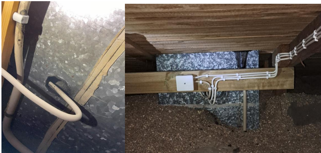
Figur 13. Samlingslåda under fläkthuv i identiskt uppförd byggnad. I fläkthuvan fanns en otätad genomföring samt att isolering och trämaterial fanns i direkt anslutning till fläkthuven.
