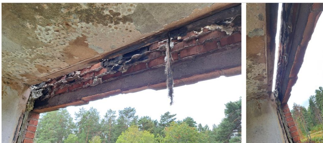
Figur 21. Bild inne i den utbrända lägenheten på plan 3 där luftspalt mellan lägenhet och vindsutrymme syns.
