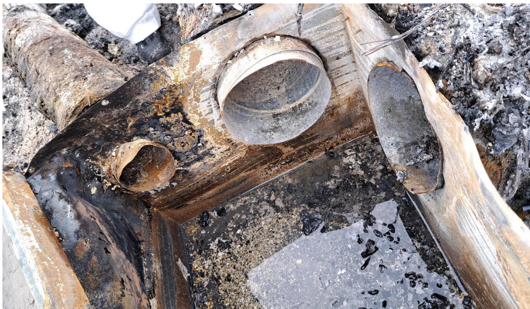
Figur 12. Den oisolerade samlingslåda som fläkthuvu var monterad ovanpå och som betjänade startlägenheten.
