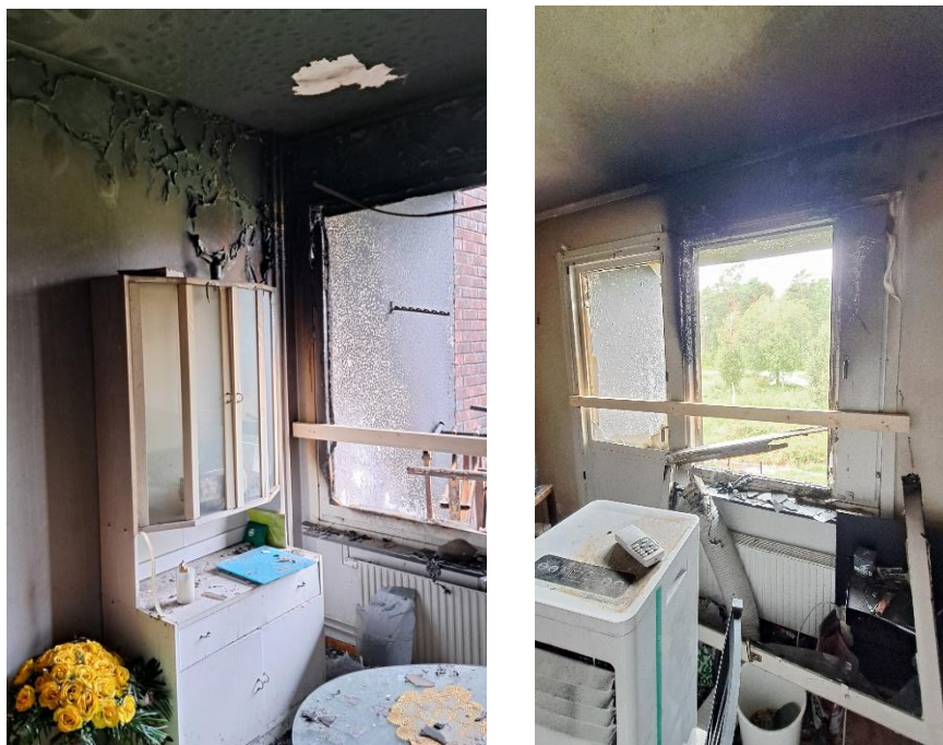
Figur 16. Bilderna visar att branden har tagit sig in i lägenheter via balkonger och altaner. Bilderna är tagna i vardagsrum mot baksidan där samtliga balkonger och altaner var belägna.
