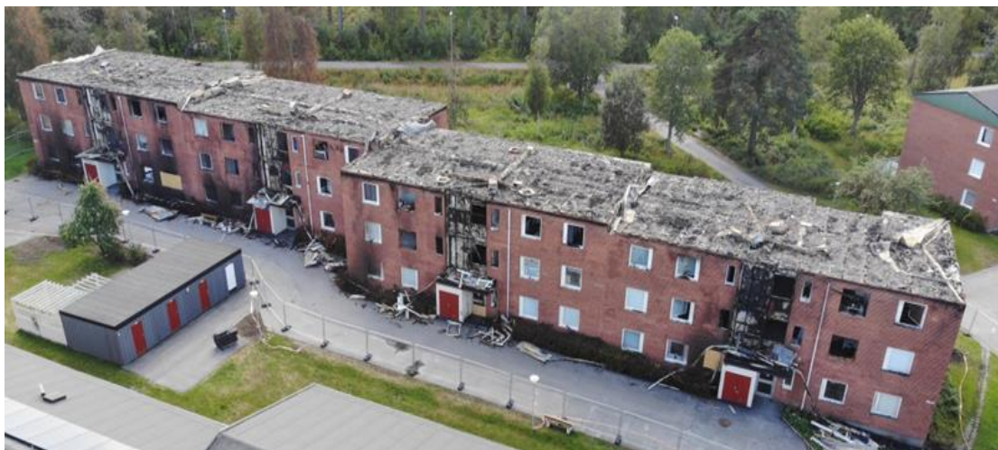
Figur 9. Översikt över byggnaden, ovanför respektive entré/förråd syns den del av fasaden där träpanelen brunnit.
