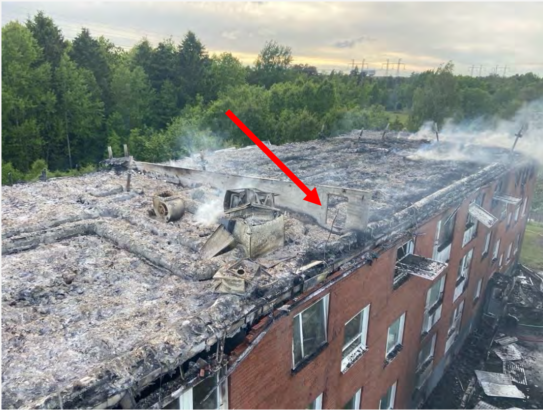
Bild 4. Pilen visar den öppna luckan i brandmuren.
