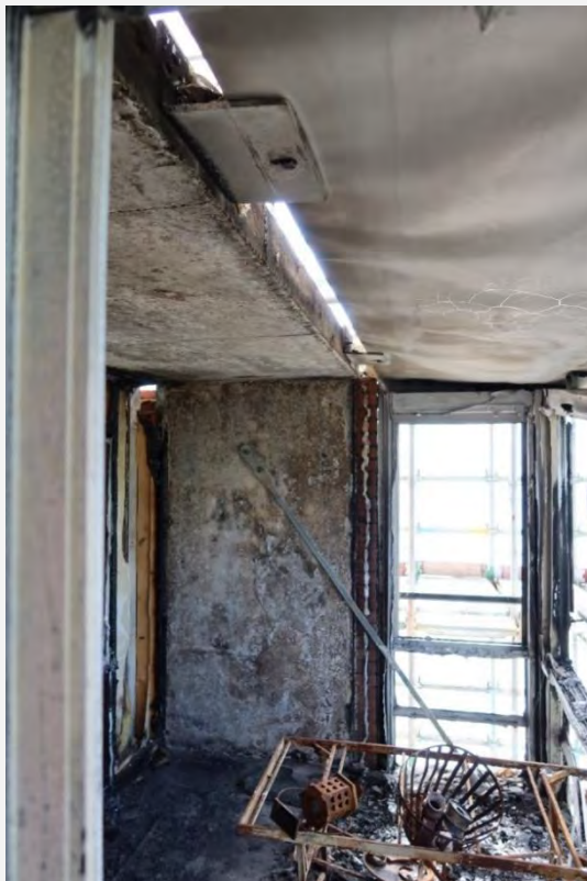
Bild 6. Glipan i taket visar anslutning mot tillbyggd balkong där plåt har suttit
