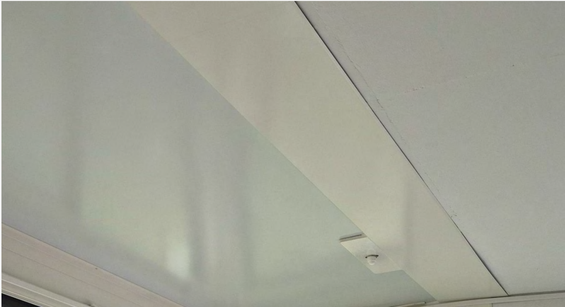
Bild 5. Den täckande plåten var inte skruvad. Bilden är från en motsvarande balkong i området.
