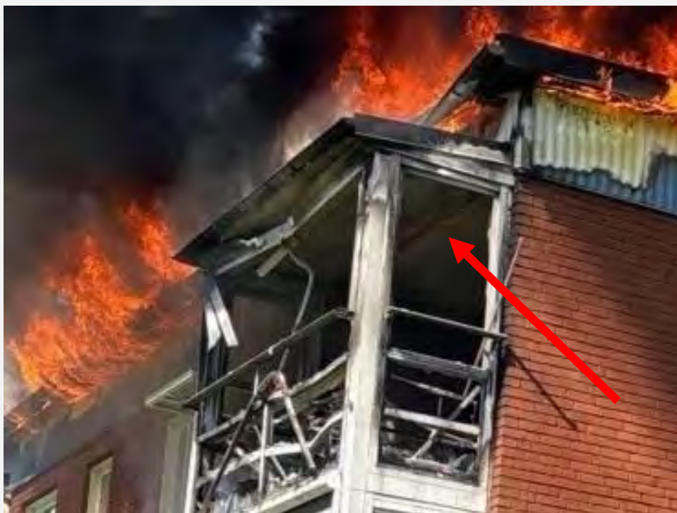
Bild 17. Plåt ser ut att saknas klockan 13:49.
