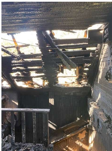
Figur 1 Yttertaket ovanför trappan
