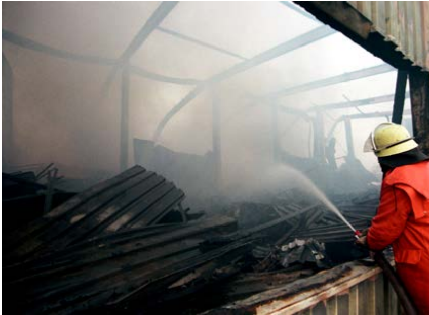
Deformation av balkar som har varit utsatta för höga temperaturer. Foto: Johnér Bildbyrå.
