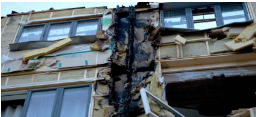
Modulhus kan medföra stora risker för konstruktionsbrand och spridning till stora delar av byggnaden. Foto: Sofie Bergström.
