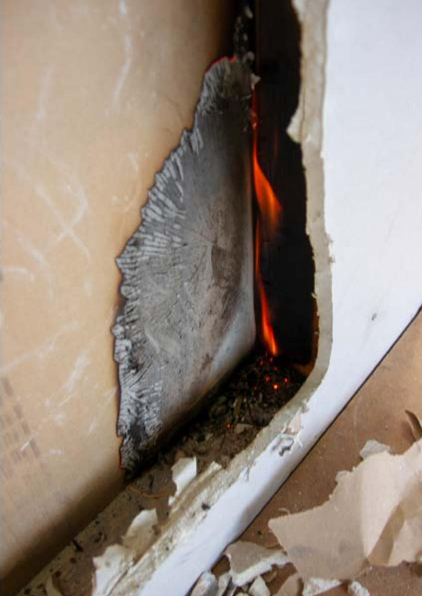
Glödbränder inne i konstruktioner är svåra att upptäcka. När till exempel en vägg bryts upp för att komma åt glödbrand, finns det risk att flamförbränning uppstår eller att branden sprids eftersom luft tillförs. Foto: Stefan Svensson.
