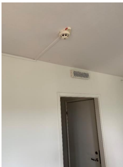
Figur 5. Tilluftsdon och rökdetektor
