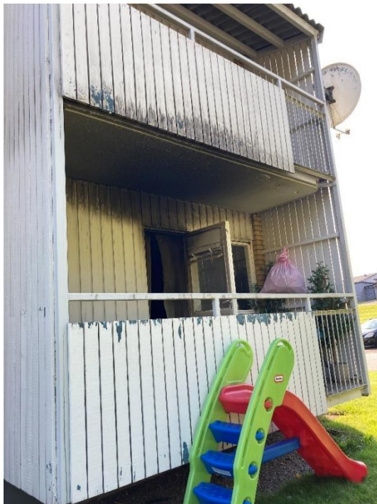
Figur 11. Sotskador på balkongen.
