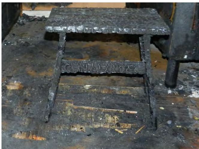
Golvet har kraftiga brandskador under pallen
