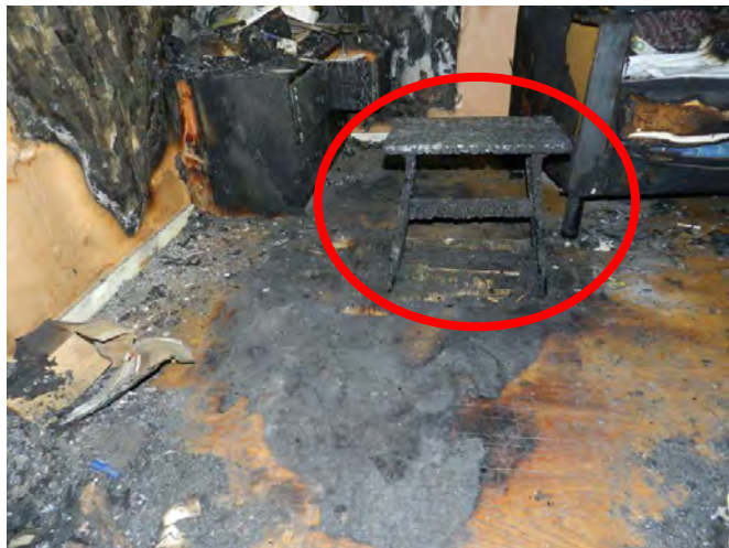
Förmodad brandstart, kraftiga brandskador i golv och på pall.
