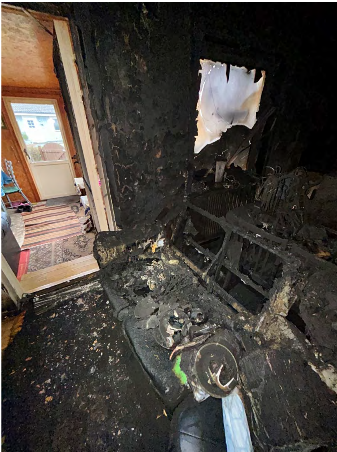
Figur 6 Soffan mitt i bild och uterummet syns i bakgrunden. Dörren ut har varit stängd hela tiden. Till vänster syns platsen där sängen stod (ej sotbelagd).
