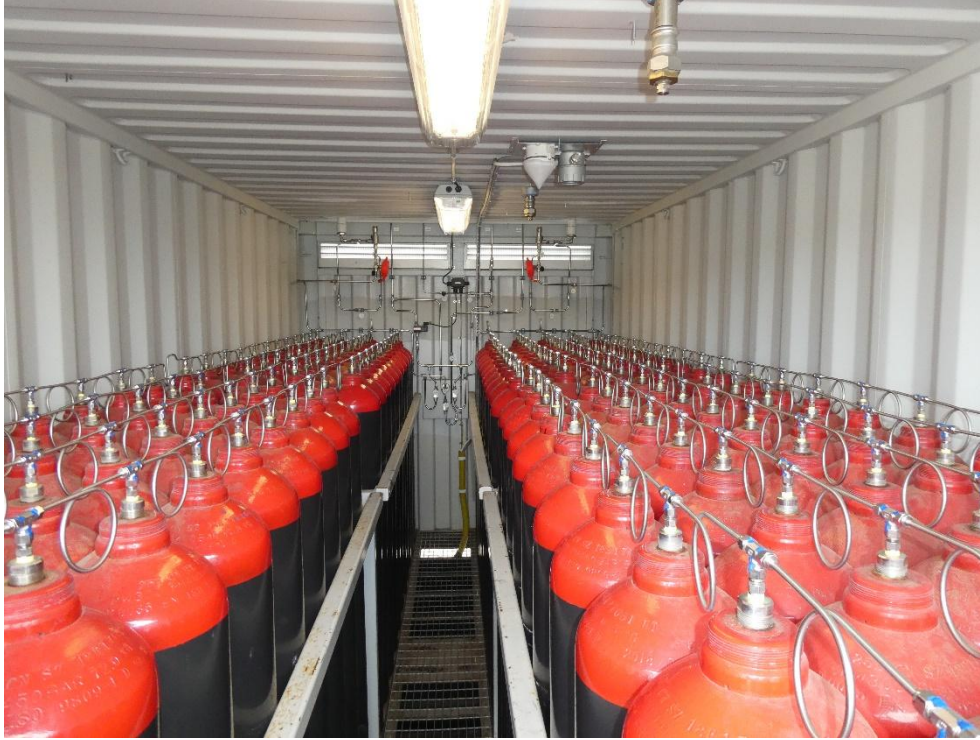
Figur 7: Gasflaskorna är parallellkopplade och placerade i tre olika containrar.
