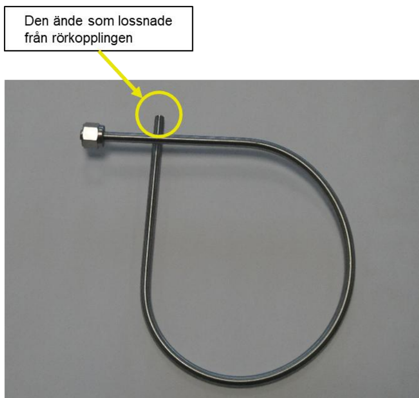
Figur 17: Gasröret som lossnade från en rörkoppling i container 6. Den änden av röret som saknar mutter var innan olyckan monterad i rörkopplingen. Den saknade muttern och de två konorna satt kvar i rörkopplingen.
