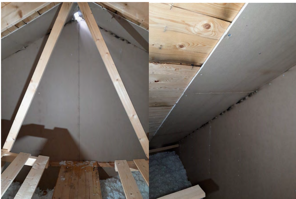
Bild 5 och 6: Inifrån vinden på 4C fotat mot begränsningslinjen till 4B där man kan se spår av att rökspridning in på vinden har skett, även förbi den förstärkande gipsskivan monterad i yttertaket.
