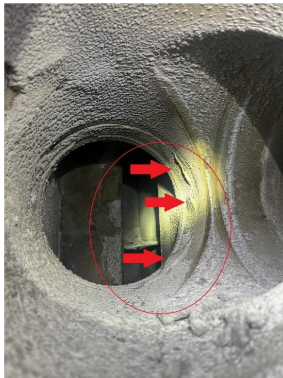
Figur 12 Pilarna visar på skador i rökkanalen i en skarvning mellan två moduler.
