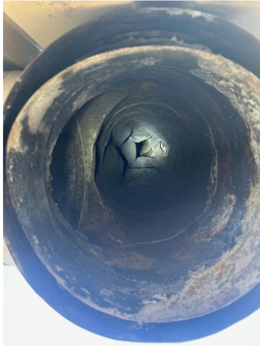
Figur 9 Insidan av rökkanalen är kraftigt deformerad vilket påvisar stor värmepåverkan.
