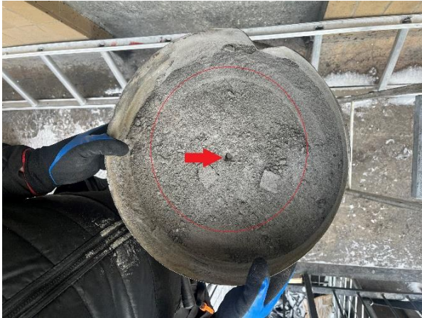
Figur 13 Pilen visar ett hål i en renslucka, ringen indikerar delar av luckan som ska vara beklädd med obrännbar isolering.
