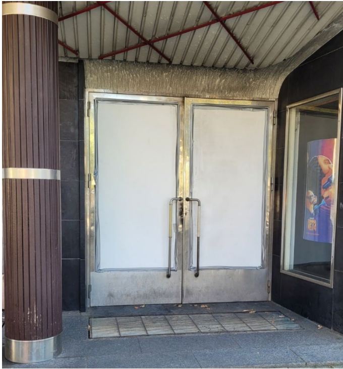
Bild 4: Vid dörrbrytet gick fönsterrutan i entrédörren sönder. En av rökdykarna upptäckte senare en skärskada på axeln som med stor sannolikhet kom från en glasbit från dörren. Räddningstjänstens bild.
