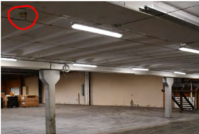
Figur 16 – Detektor synlig i tak under kontorsdelar i eventföretagens lokal. Kan antas höra till äldre larmanläggning som ej var i drift vid tillfället för branden.
