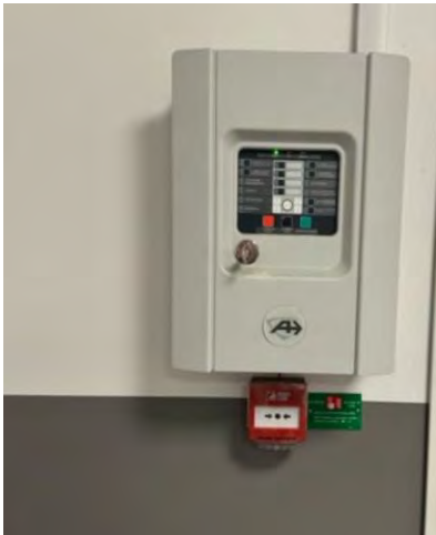
Figur 20 – Centralapparat brandlarm i eventbranschföretagens lokal. Klipp från sammanställning brandinventering dat. 24-02-26.
