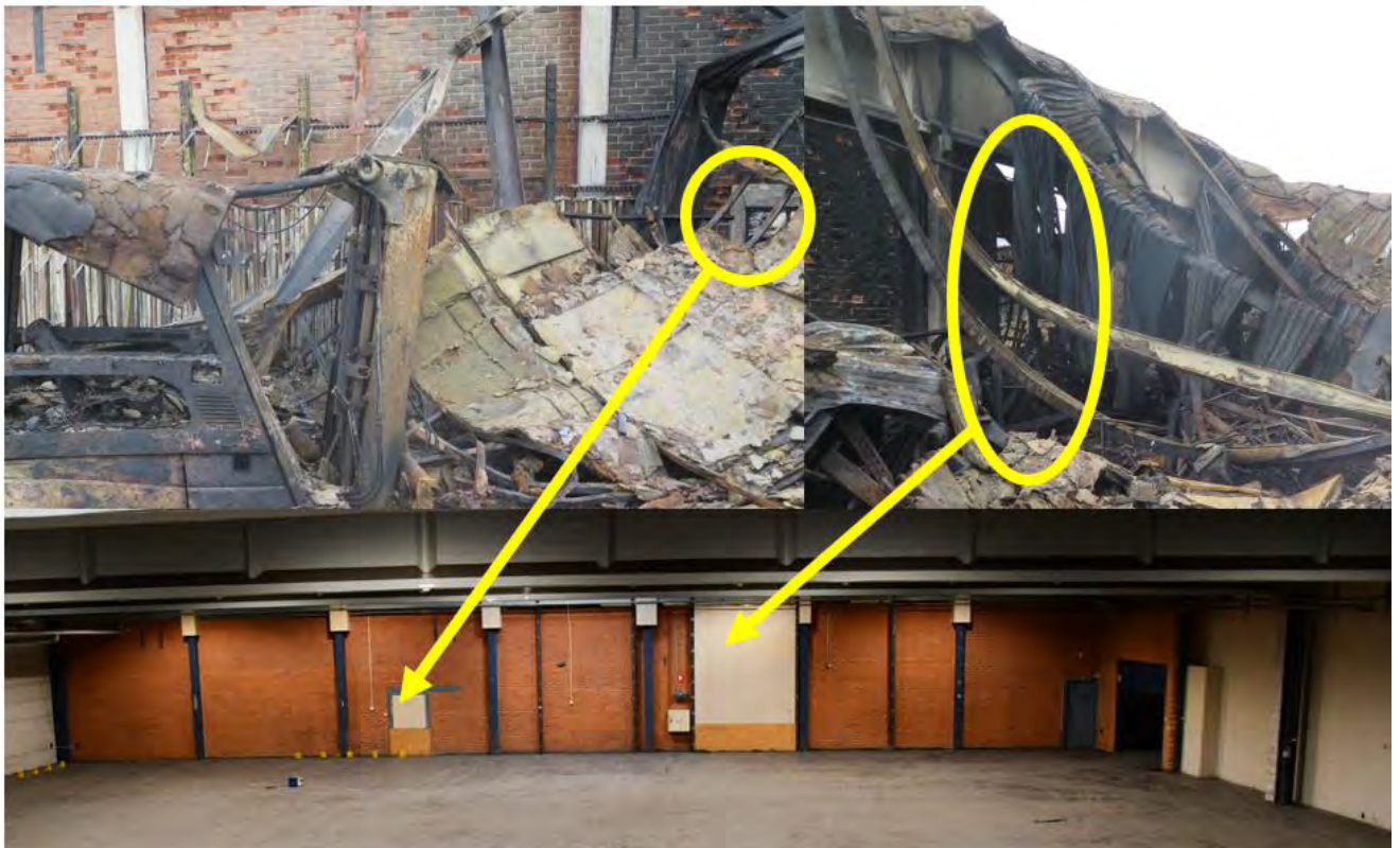
Figur 34 – Två öppningar observeras i tegelväggen från eventföretagens lokal mot lagerservicelokalen vid undersökning 240321 och dessa bör kunna härledas till igensatta öppningar i väggen som kan iaktas i foto erhållet från representant för eventbranschföretag, taget i samband med inflyttning till lokalen. Det bedöms att dessa öppningar (antagligen en dörr och en port) har satts igen med gipskonstruktion.
