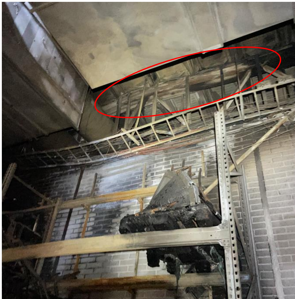
Figur 8 - Stålbalk i tak som deformerats på grund av värmepåverkan, inringat i rött.
