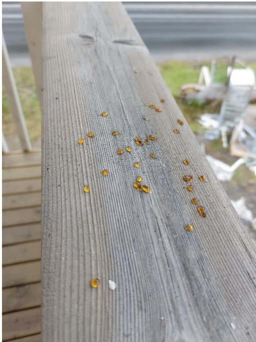
Figur 13. Att träarket svettats kåda är ett tydligt tecken på en hög värmestrålning mot angränsande byggnad.
