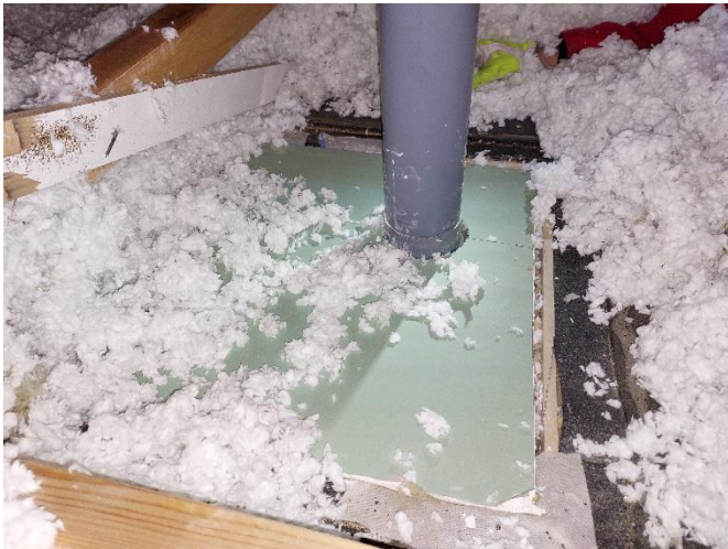
Figur 10. Genomföring av avluftningsrör i schakt. Löst sittande gipsskiva som gick att lyfta bort.
