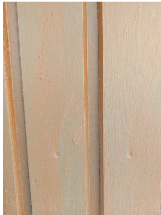
Figur 15. Tecken på att tjockleken på brandskyddsfärgen varit ojämn då underliggande färg (grå) lyser igenom.
