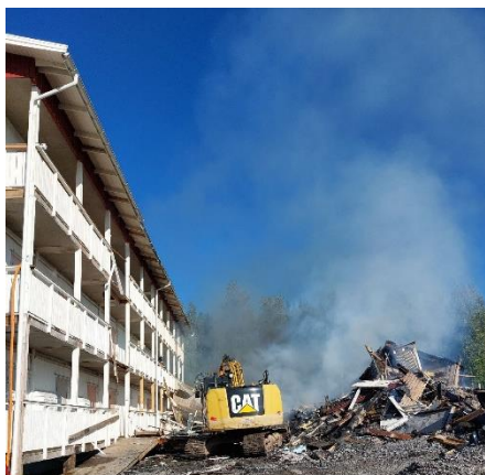
Figur 6. En grävmaskin hjälpte till att skapa distans till den odrabbade byggnadskroppen. Bilden är tagen klockan 12:06.
