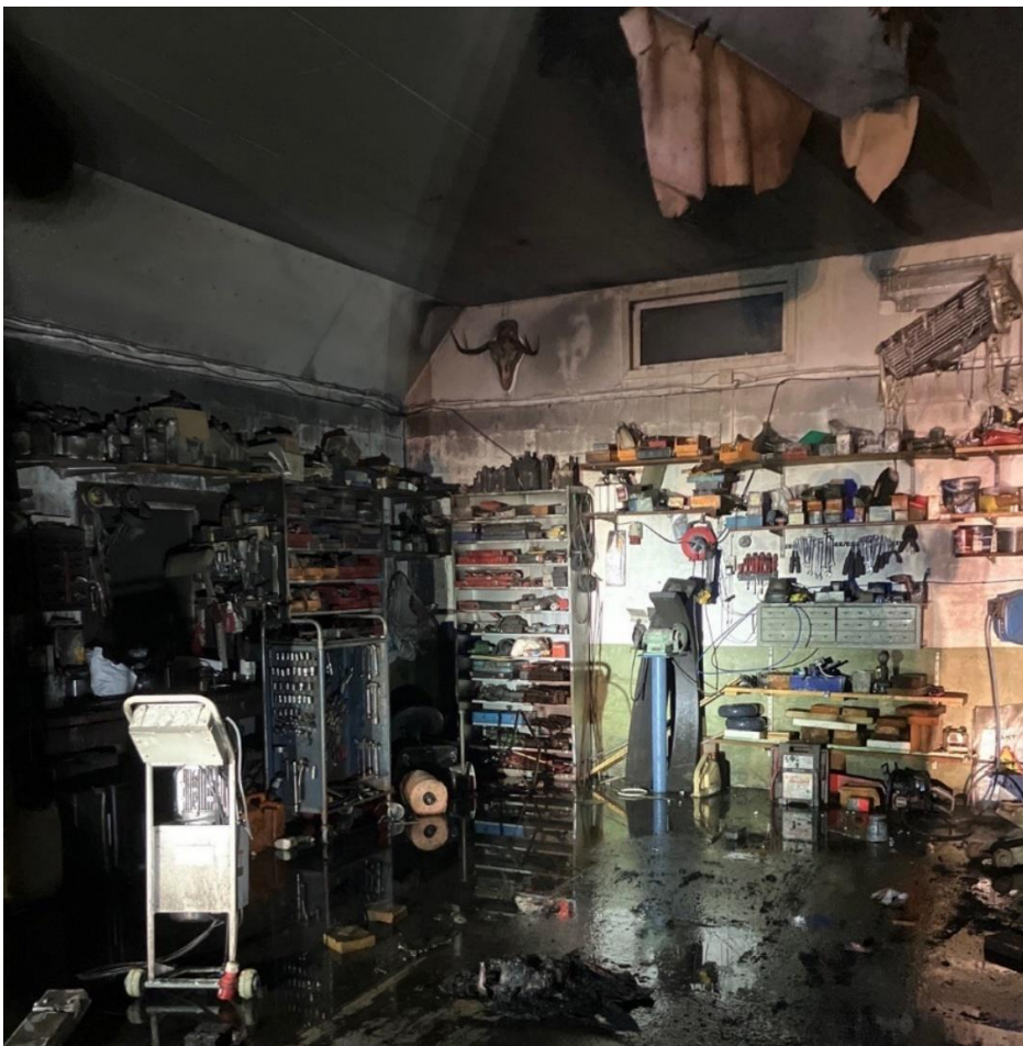
Figur 3. Garaget efter att branden är släckt och bilen dragits ut.
