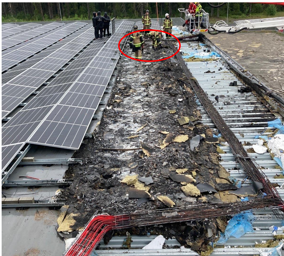
Figur 2 visar brandområdet på taket. Inringat område bedöms vara brandens primärområde samt där det brann som mest när en brandman kommer upp på taket kl. 17:13. Foto taget av räddningstjänsten vid eftersläckningsarbetet kl. 21:27, 2023-07-17.
