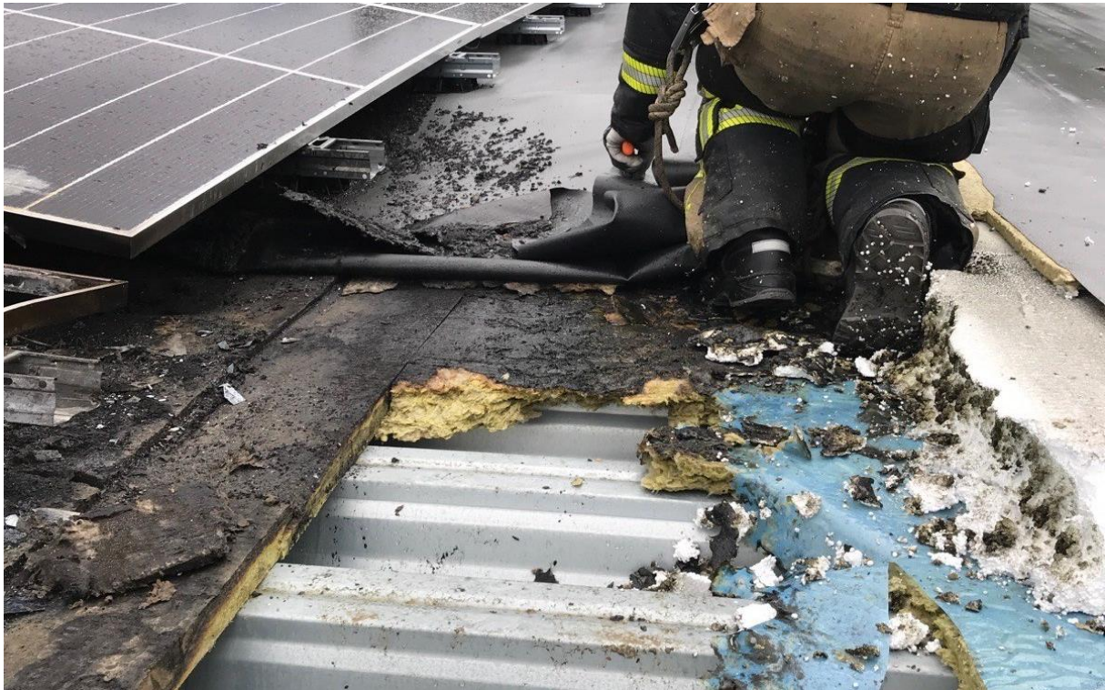
Figur 1 visar takisolering vid brandområdet. Foto taget av Räddningstjänsten Jämtland, kl. 19:32, 2023-07-17 vid eftersläckningsarbetet strax efter branden släckts.
