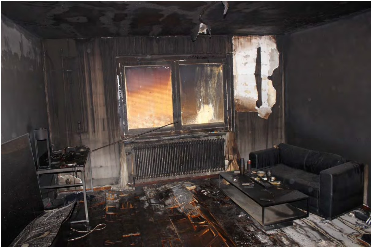
Figur 18. Bild på brandskador i vardagsrummet (benämnd som rum A)
