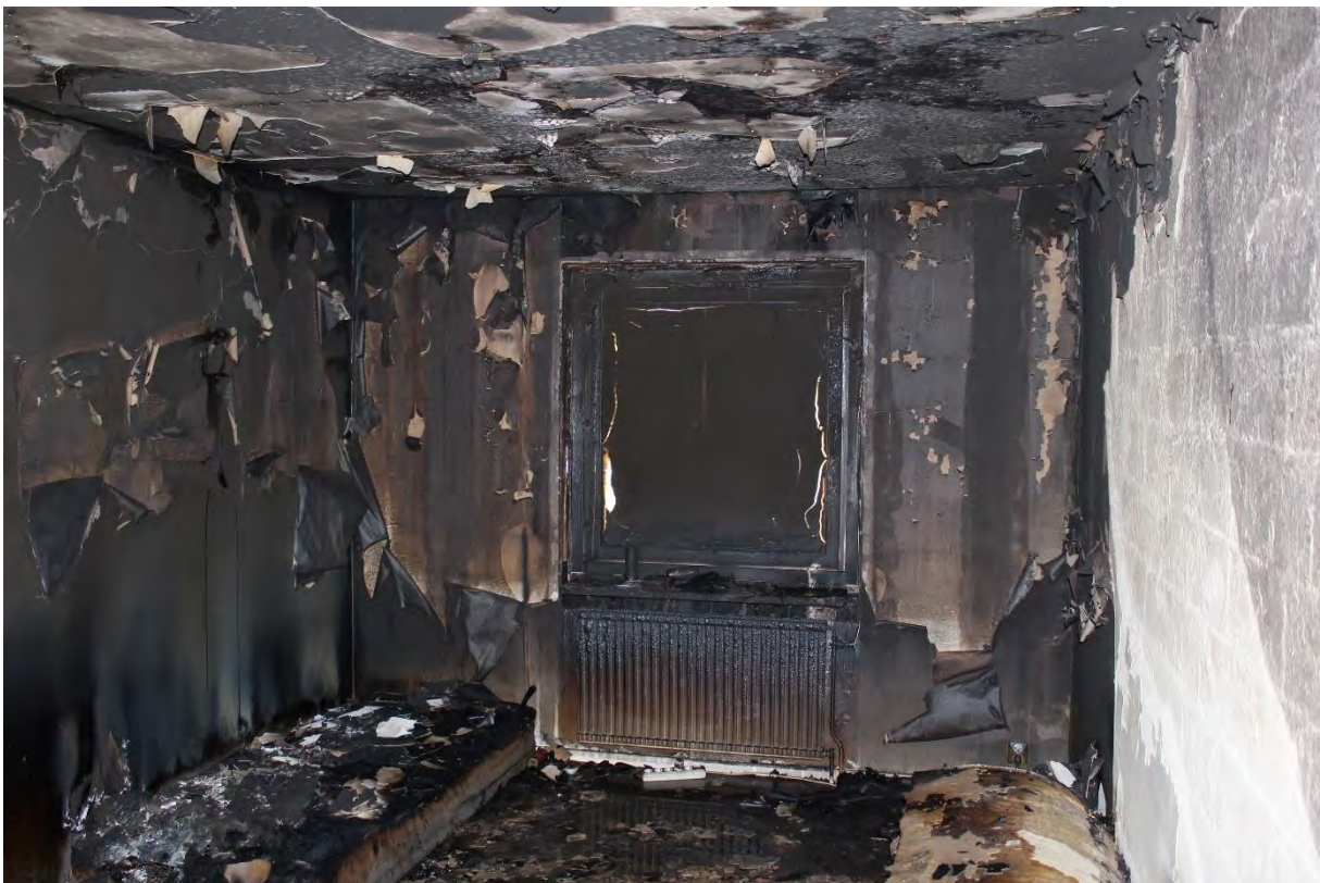
Figur 21. Bild på brandskador i rum B.
