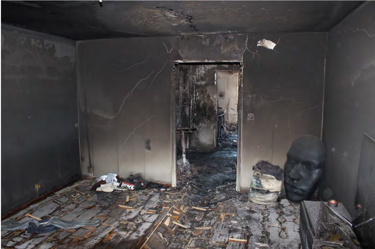
Figur 19. Bild på brandskador i golvet i vardagsrummet.
