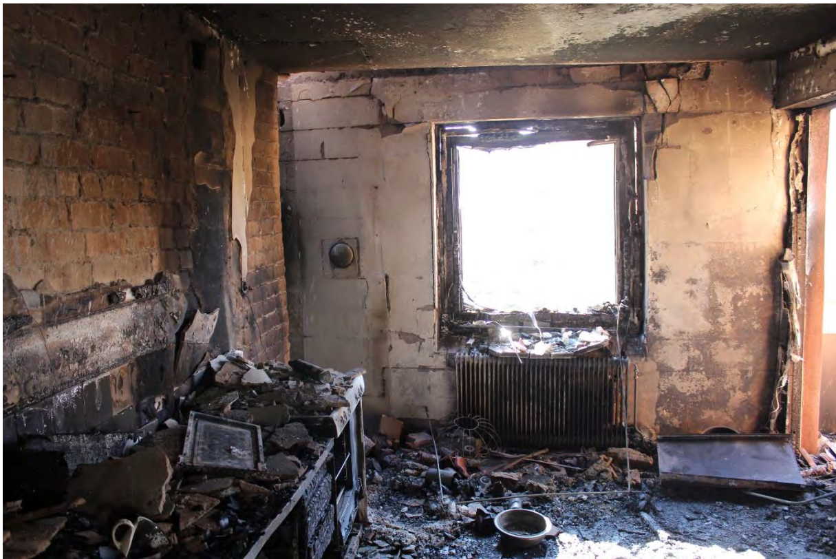
Figur 14. Bild på köket med omfattande brandskador i hela utrymmet.
