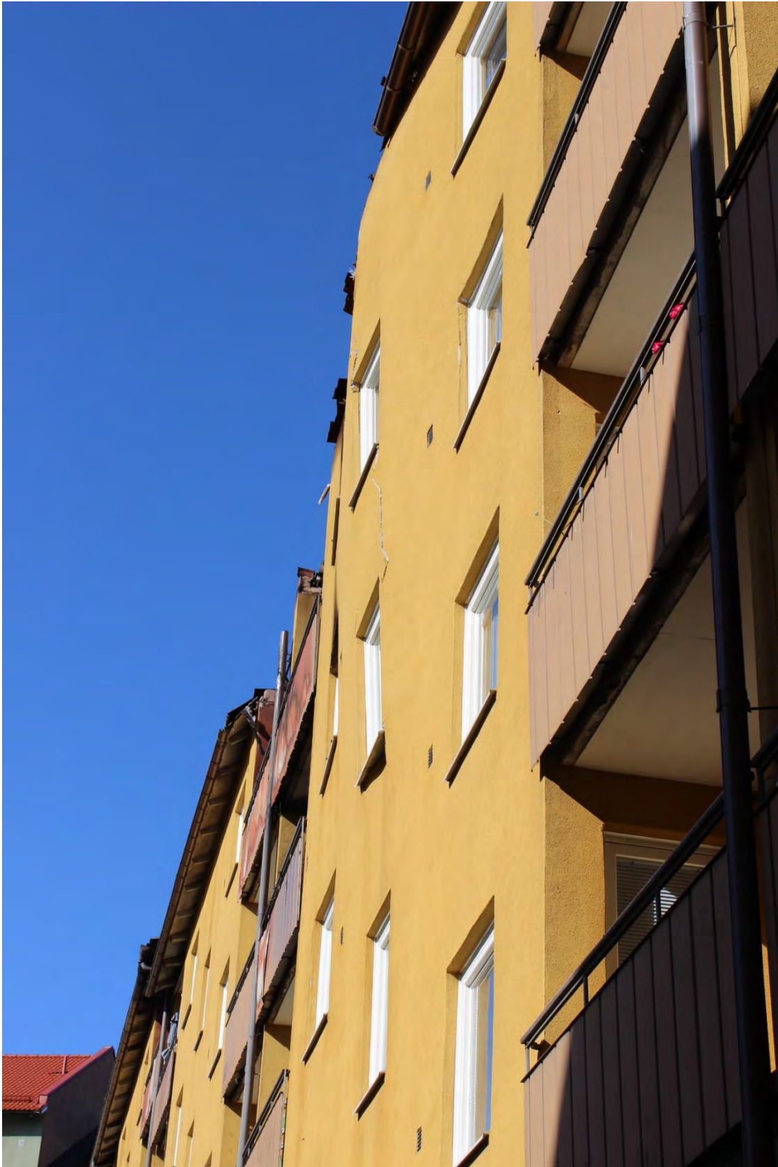
Figur 6. Bild på husets fasad som visar tydligt hur den buktar ut som ett resultat av att ytterväggen skadats av tryckvågen.
