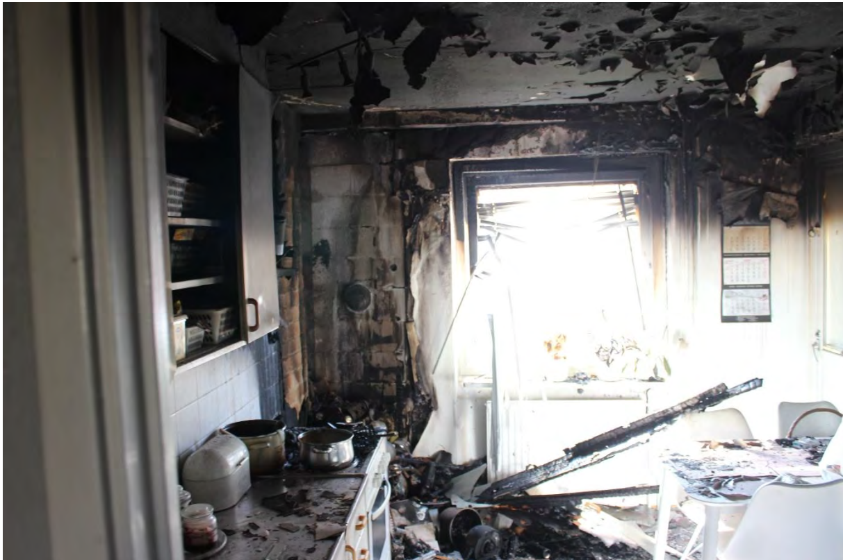
Figur 25. Bild på brandskador i lägenheten under startlägenheten. Brandspridning skedde snabbt ned hit genom det mellanrum vid ytterväggen som bildades vid explosionen.
