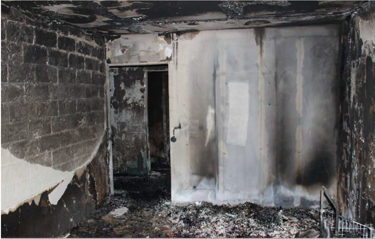
Figur 20. Bild på brandskador i rum B.
