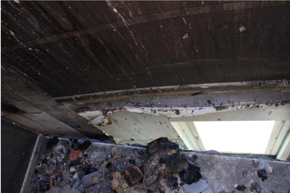
Figur 8. Bild från trapphuset som visar hur ytterväggen tryckts ut från bjälklagen och att det bildats ett mellanrum mellan yttervägg och varje våningsplan.
