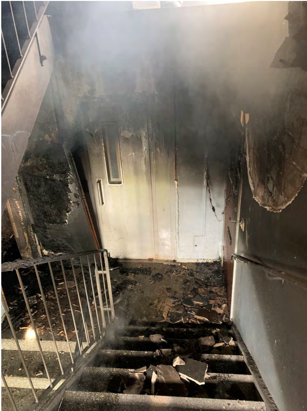
Figur 9. Bild på trapphusets översta del. Till vänster i bilden syns resterna av lägenhetsdörren till den primärt drabbade lägenheten. Dörren har fläkts upp och stod öppen när rökdykare kom upp i trapphuset.
