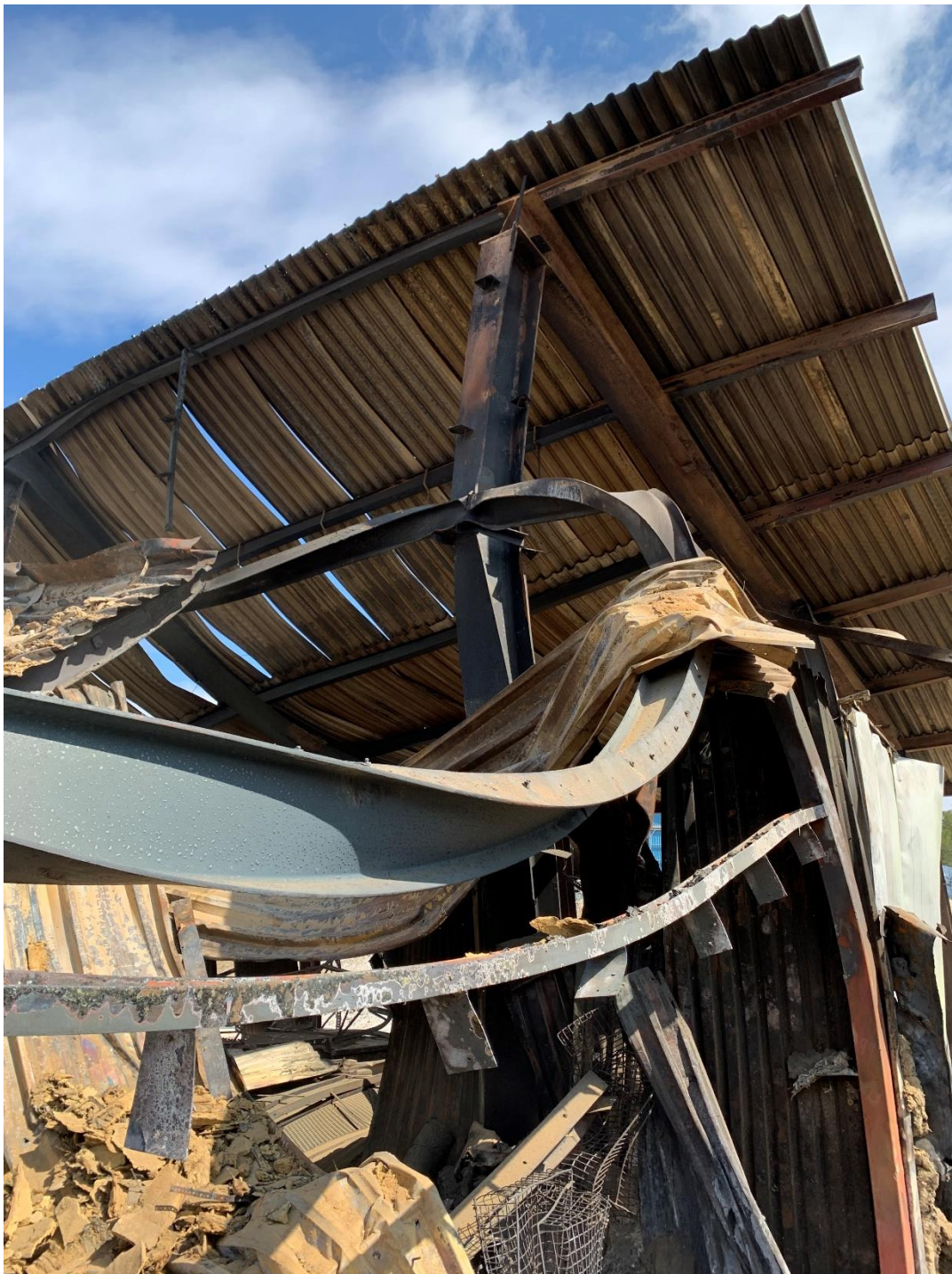
Figur 15 Bild från brandplatsundersökning 2023-06-08, kollaps av bärverk i gränslinje mellan listhall och butik i nordöstra delen av bygganden.
