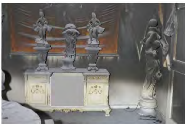
Figur 9 sotskador i vardagsrummet
