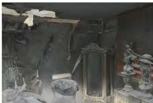
Figur 10 sotskador i vardagsrummet
