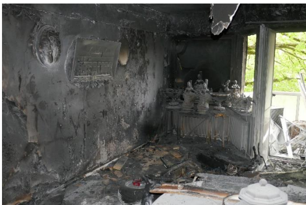
Figur 12 brandskador i vardagsrum, på bilden ses även den brandskadade elmopeden
