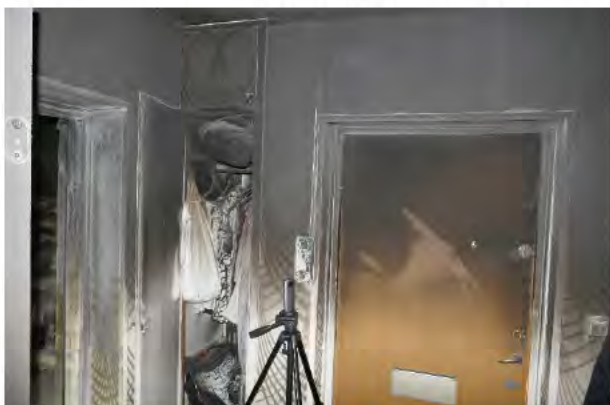
Figur 7 sotskador i hallen
