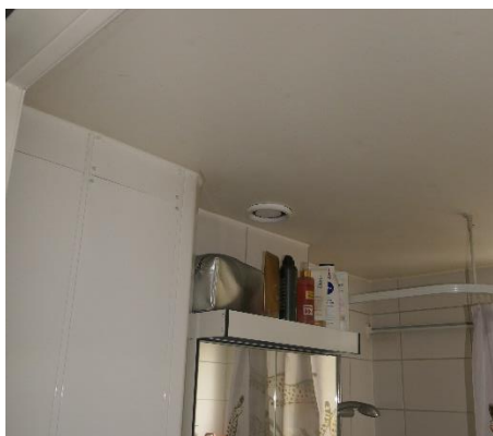
Figur 6 badrummet, relativt opåverkat av brandrök
