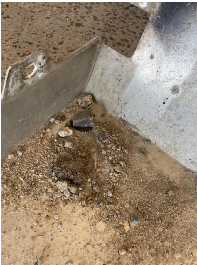
Bild 10 Demonterade kas/skyddsplåtar som visar ansamling av grus/sten.
