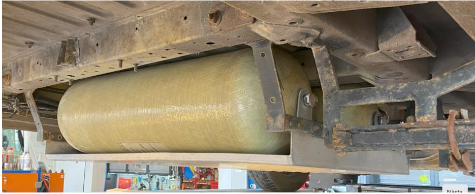
Bild 15 Hur skyddsplåt för främre gastankar på ombyggd buss ser ut sett bakifrån.
