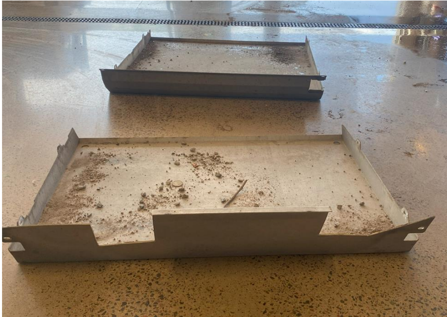
Bild 9 Demonterade kas/skyddsplåtar som visar ansamling av grus/sten.
