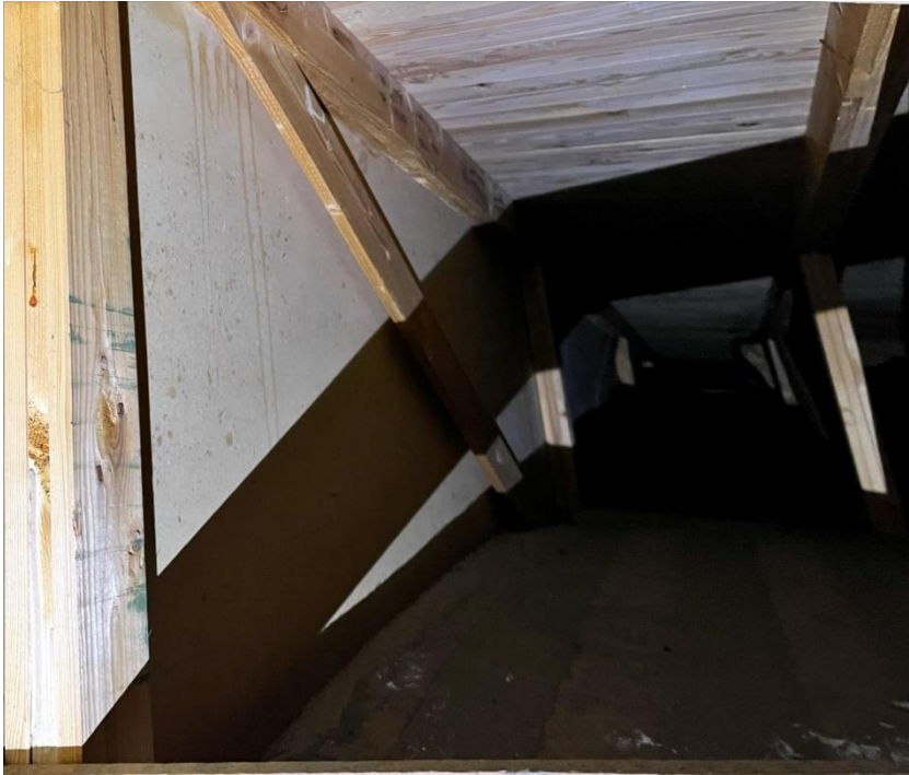
Figur 14 Bild på avskiljning från vind i grannhus från platsbesök
