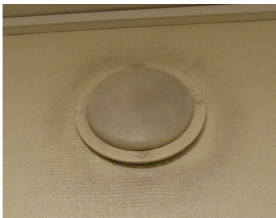
Bild 4. Ventilationsdon i korridor mellan lägenheter och trapphuset.
