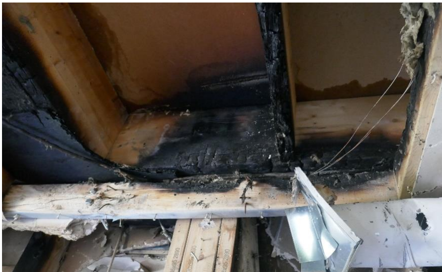
Figur 21. Brandskador i bjälklag mellan plan 4 och 5. Bild tagen underifrån upp i bjälklaget.
