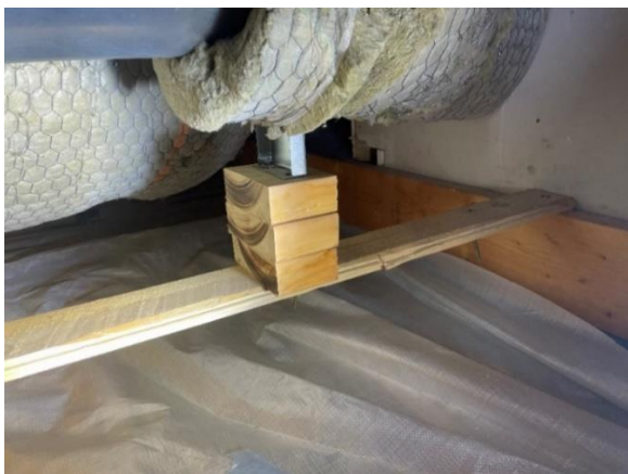
Figur 31. Upphängningen av ventilationskanaler på vinden var utförda med bland annat træklossar, råspont samt mindre träreglar.
