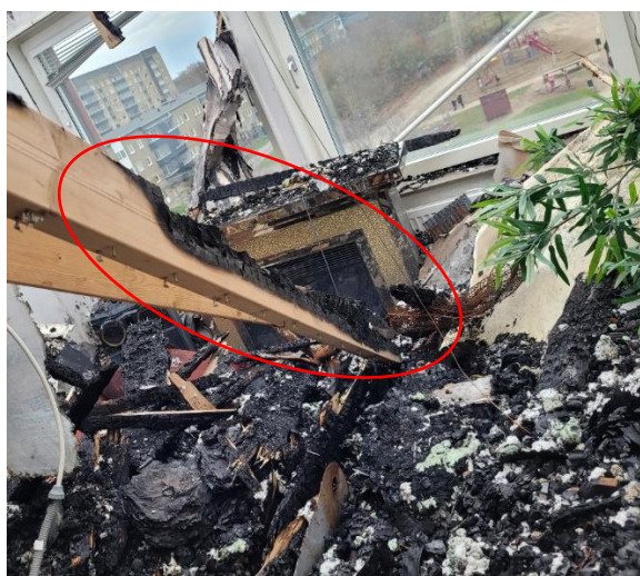
Figur 18. En nedfallen balk i lägenhet på plan 5 som var kraftigt kolad. Den inringade delen har varit placerad närmst yttervägg, mellan lägenhet och kattvind.
