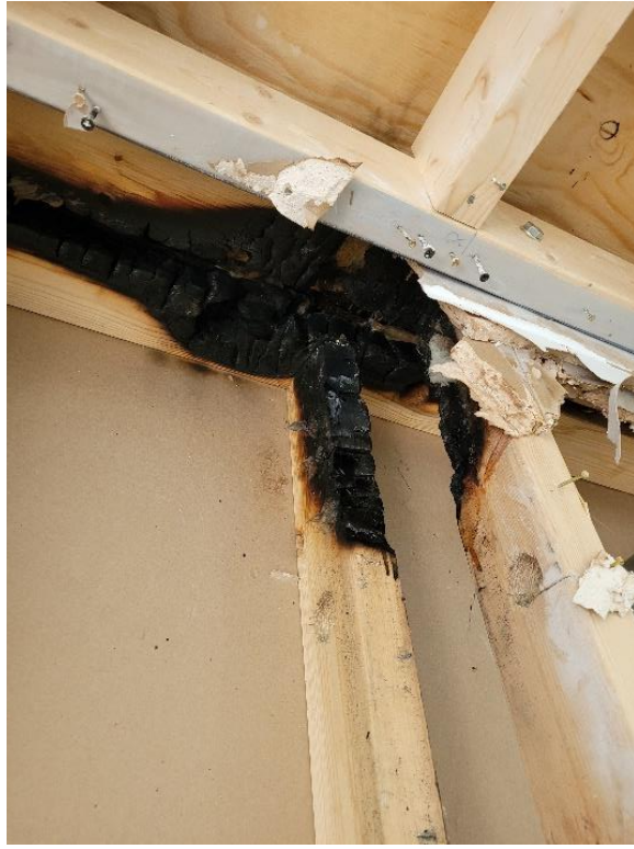
Figur 24. Brandskador i hålrummen mellan modulerna noterades ner till plan 3. Bilden är tagen underifrån in i modulskiljande vägg i lägenhet på plan 3.
