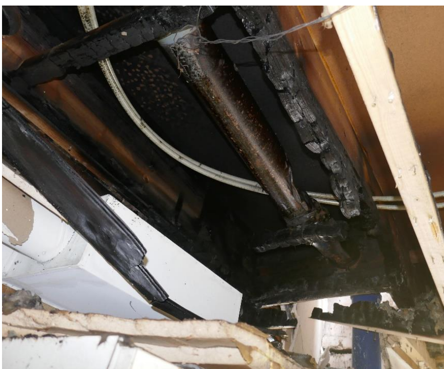
Figur 22. Brandskador i bjälklag mellan plan 4 och 5. Bild tagen underifrån upp i bjälklaget.
