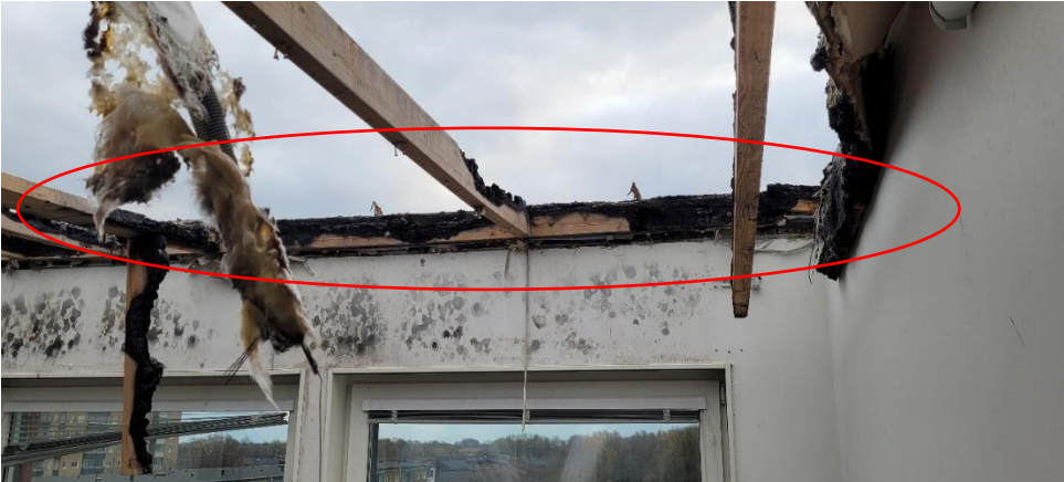
Figur 20. Träregel, inringad, längs med yttervägg mellan plan 5 och vind var brandskadad.
