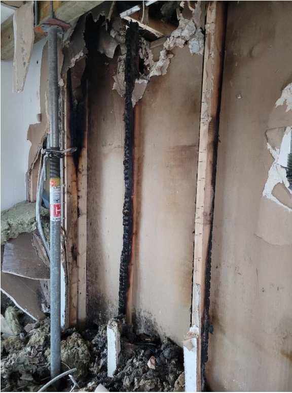
Figur 23. Brandspridning i vägg mellan trapphus och lägenhet, plan 4.
