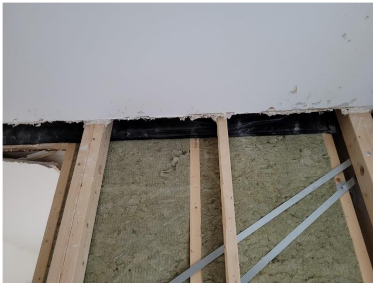
Figur 26. Brandstoppens placering i hålrummet. Brandstopp ligger mot isoleringen nedanför den horisontella träregeln i modulens tak.
