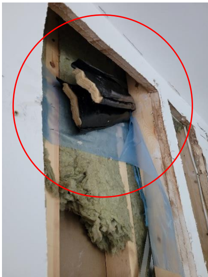
Figur 25. Brandstopp, inringat, i hålrummet mellan två moduler. Mineralullsremsa inklädd i plast. Håltagning i vägg har räddningstjänstens personal gjort vid insatsen.
