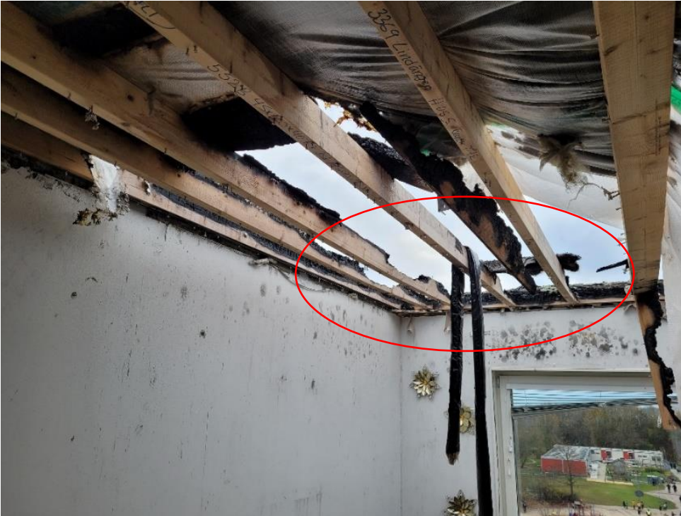
Figur 19. Lägenhet på plan 5. Balkar i vindsbjälklaget är kraftigt brandpåverkade, speciellt den del som varit mellan lägenhet och kattvind, inringat.
