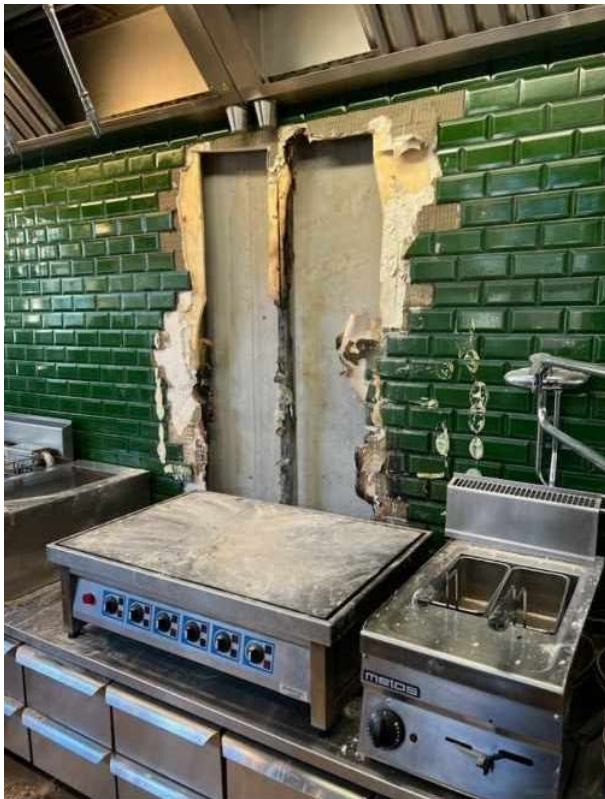
Figur 1. Brandutsatt vägg i samma restaurangkedjas lokaler i Norrköping 2022. Foto taget av verksamheten.
