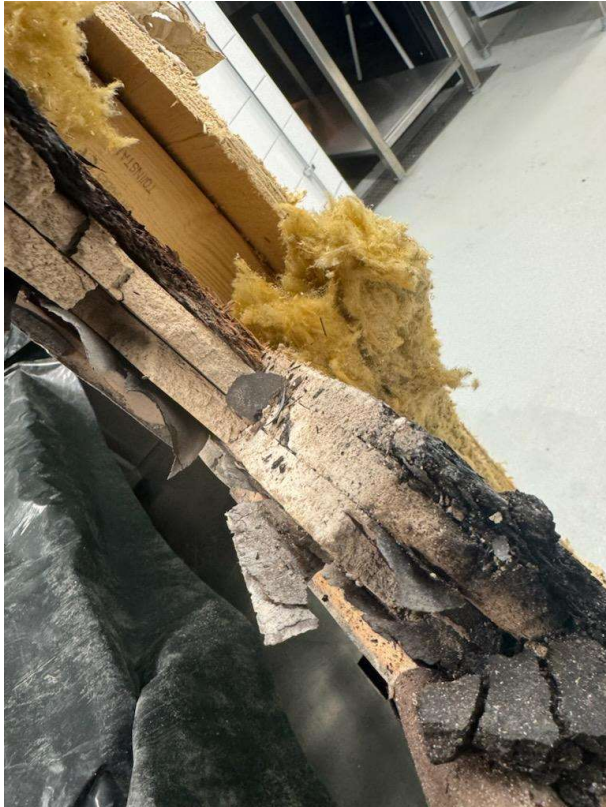
Figur 5. Foto där vägghkonstruktionen framgår, taget av hantverkare under brandkvällen.
