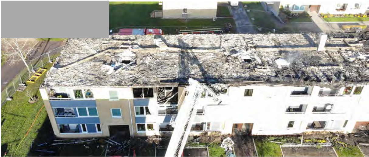
Figur 23 - Drönbild polisen 2022-11-09 som visar del av byggnaden, taket och framsidan. Ingång ■ C till vänster i bild.
