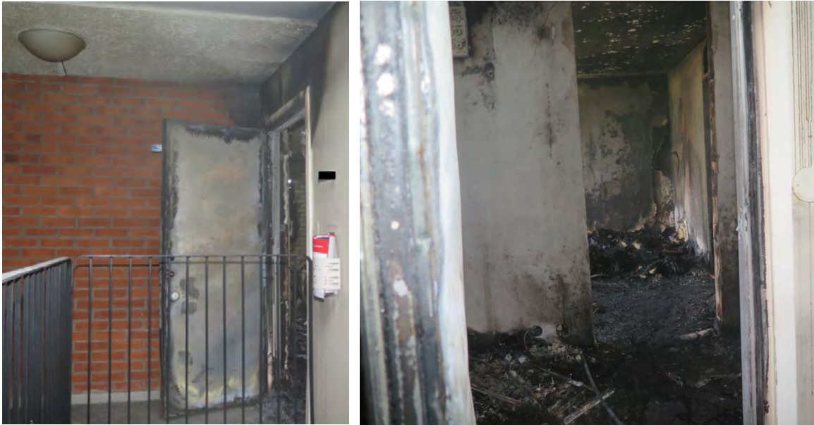
Figur 27 - Foton från platsbesök 2022-11-11. Lägenhetsdörren (t.v.) är kraftigt brandpåverkad på insidan. Inga tecken på höga temperaturer i trapphuset annat än ovanför dörren (se opåverkat pappersmaterial i tidningshållare). Dörren har varit stängd under brandförloppet men släppt igenom rök. Foto t.h. visar den branddrabbade lägenheten sedd från ytterdörr, hallen närmast i bild och vardagsrummet längst bort i bild (hörnet där bokhylla och fåtölj stått).
