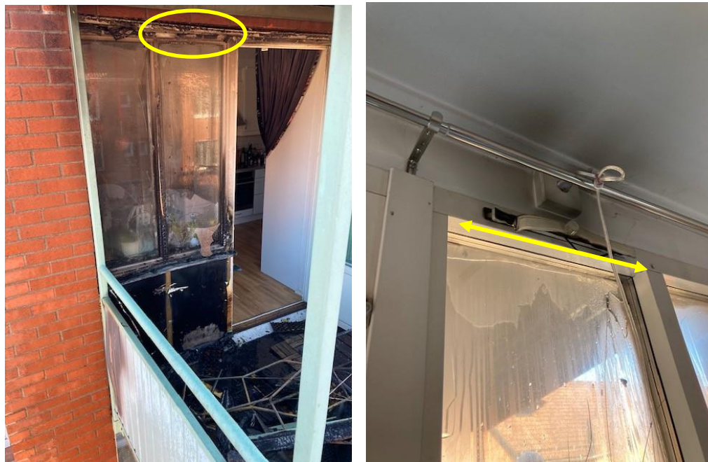
Figur 6 och 7. Rökspridning in i lägenheten skedde via luftintag markerad. Sot synlig vid lamputtag, vägg och tak i lägenheten.
