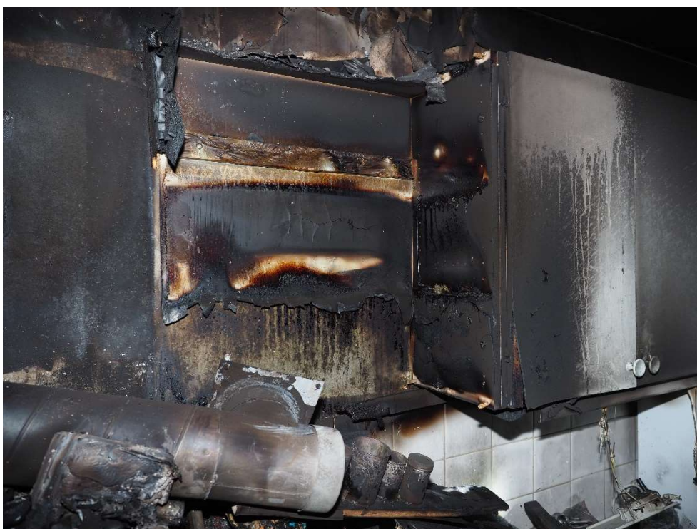
Bild 10: Vid en närmare titt på överskåpet till höger om spisen syns att bakstycket helt brunnit bort längst ned och även att kakellisten som sitter under överskåpet brunnit helt av.
