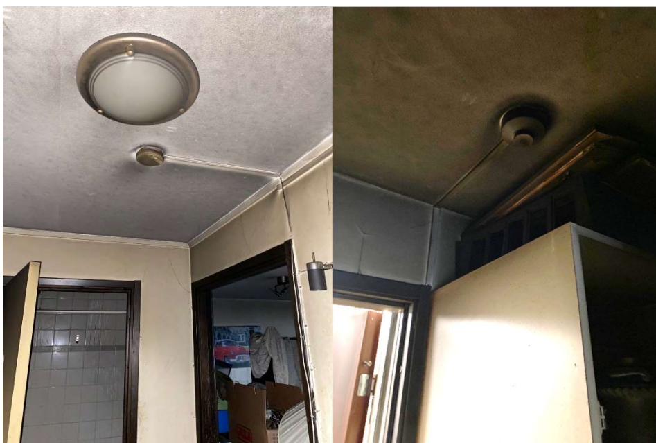
Bild 4: I hallen finns två brandvarnare. Ingen av dessa har fungerat. Bilden till höger visar en rökdetektor som normalt finns i automatlarmsanläggningar. Denna är troligtvis kvar från tidigare verksamhet men var vid brandtillfället troligtvis inte inkopplad. Detta kan skapa en falsk trygghet hos boende då dessa lämnas kvar efter att de kopplats ur.
