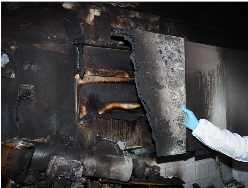
Bild 11: Köksluckan hittades på golvet och då den hålls upp på det sätt den varit monterad så syns att brandskadorna är kraftigare i nederkant än i överkant, vilket avviker från det normala brand-V:et.
