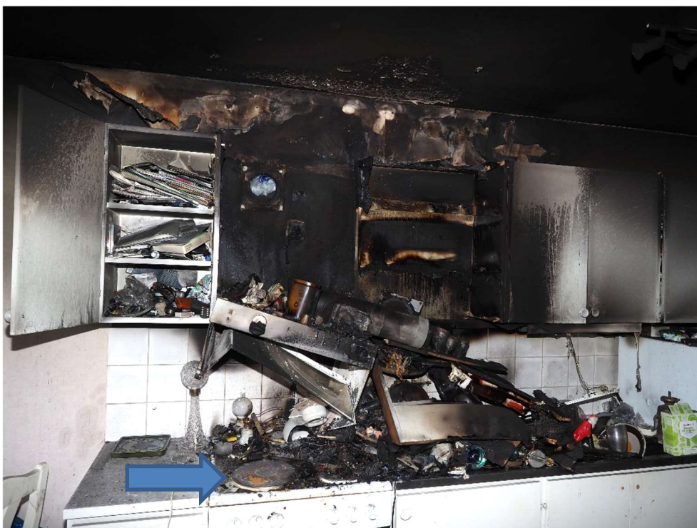
Bild 9: Översikt av brandskadorna i köket. Pilen visar plattan som rökdykarna stängde av och rensade från brännbart material. Brandskadorna i taket tyder på att branden varit som kraftigast i överskåpet till höger om spisen.
