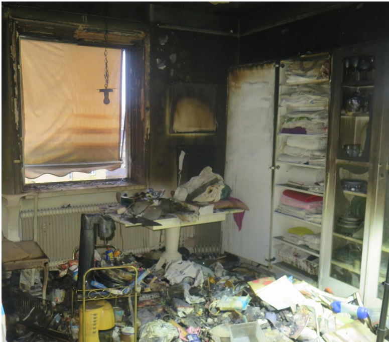
Köket i den branddrabbade lägenheten. Del närmast köksfönster.
