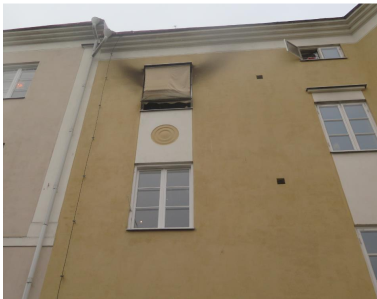
Köksfönster hörande till branddrabbad lägenhet plan 3. Markis bedöms ha släppt och fallit ner framför fönster efter branden. Högst upp till höger syns mindre fönster hörande till trapphus.
