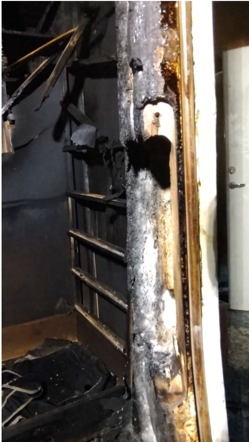
Dörrblad in till sovrummet rejält brännt.
