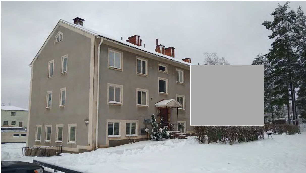
Brandlägenheten syns längst bort, fönster övertäckt efter branden.
