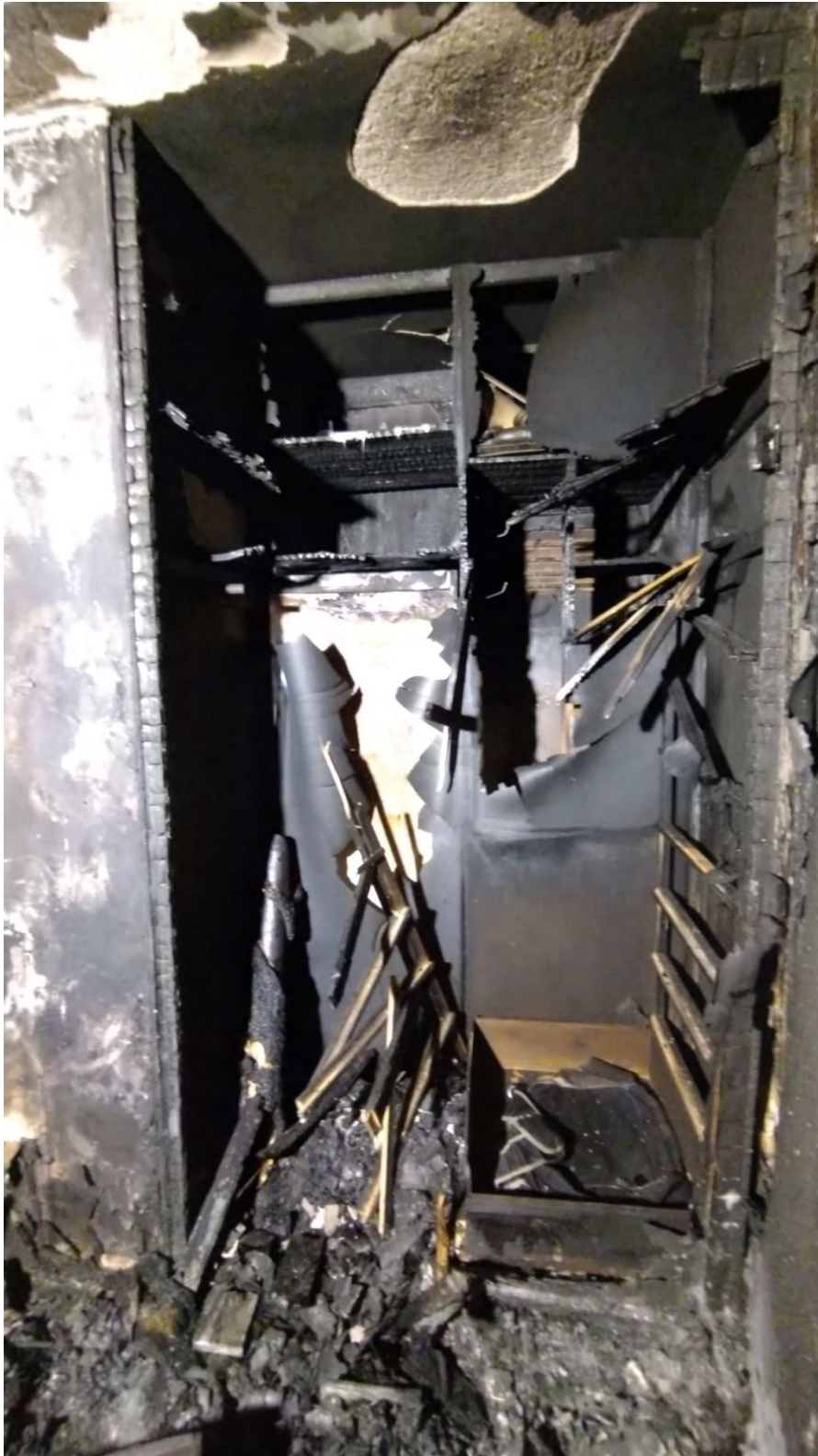
Brand och rök spred sig via garderob och köksskrubb, från sovrummet.
