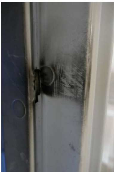
Figur 2. Tätningsslistan på dörren var trasig på ett ställe.
