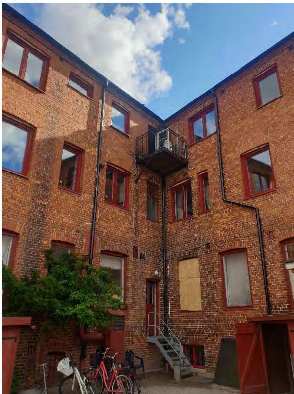
Bild 2 – Ingång från gårdssida. Fönster i brandutsatt lägenhet försedd med träskiva.
