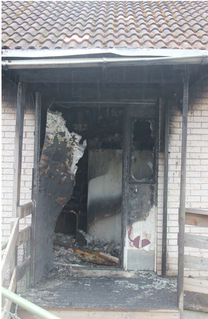
Bild 3 Östra entrén där det primära brandområdet fanns innanför ytterdörren
