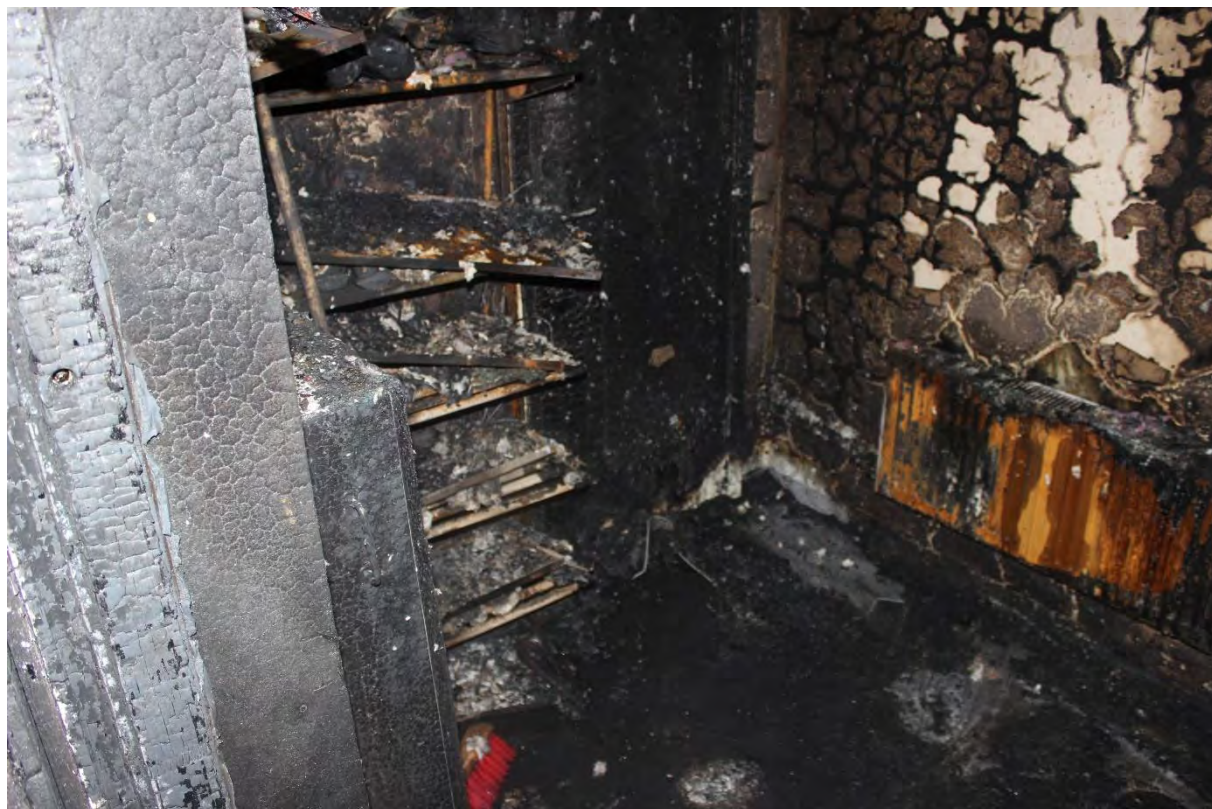
Bild 5 Brandskador till vänster om det primära brandområdet. I hörnet och framför elementet påträffades det hopsmälta kläder på golvet. På hyllan har det stått skor.
