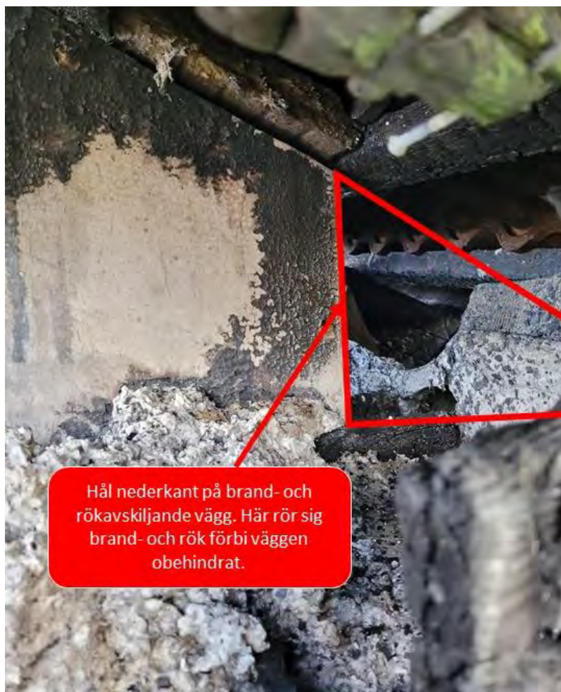
Bild 8 Nederkanten vid takfoten av den vägg som fanns i mitten av byggnaden. Kanten är rak, det syns inga tecken på att gips brutits eller rasat ned vid branden, utan hålet bedöms ha funnits där vid brandstart.
