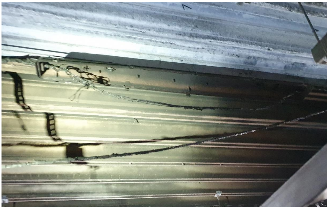
Figur 2. Resterna av den värst brandpåverkade belysningsarmaturen. Bild tagen vid återbesök.
