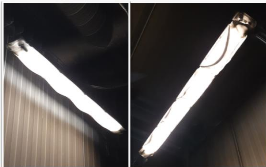
Figur 3. Exempel på andra, mindre brandpåverkade, belysningsarmaturer i fårstallet. Bilder tagna under insatsens genomförande.
